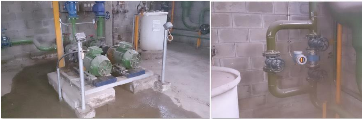
Figura 24: Motores de alto rendimento e caudalímetro após a instalação
