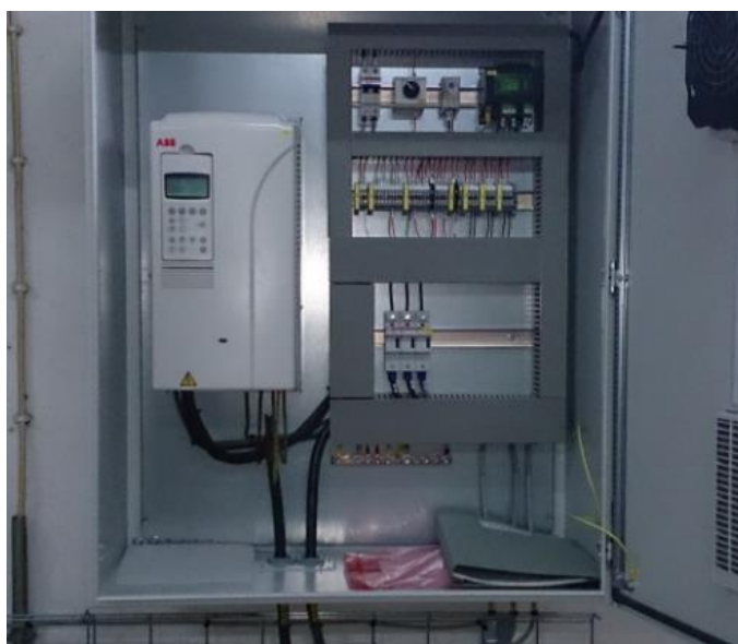
Figura 33: VEV com as ligações de potência e comando após instalação
