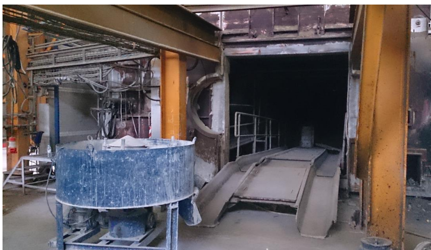
Figura 60: Entrada do Forno 3 durante a manutenção anual [Fonte: Cimpor]
