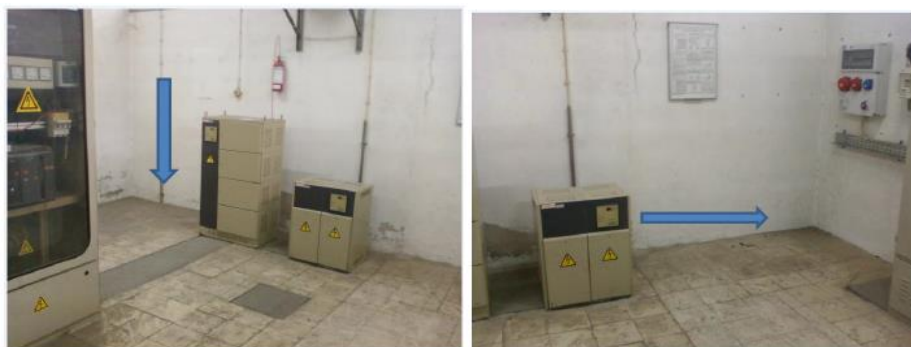
Figura 21: Fotos da futura instalação do quadro dos VEV's
