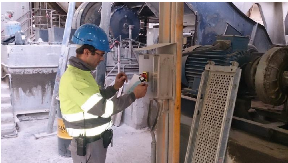
Figura 63: Responsável da Consignação a proceder ao corte de energia no ICL [Fonte: Cimpor]
