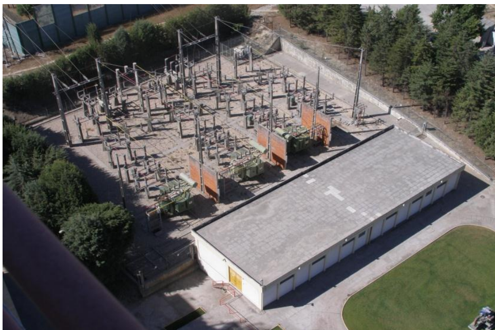
Figura 2: Vista aérea da subestação [Fonte: Cimpor]
