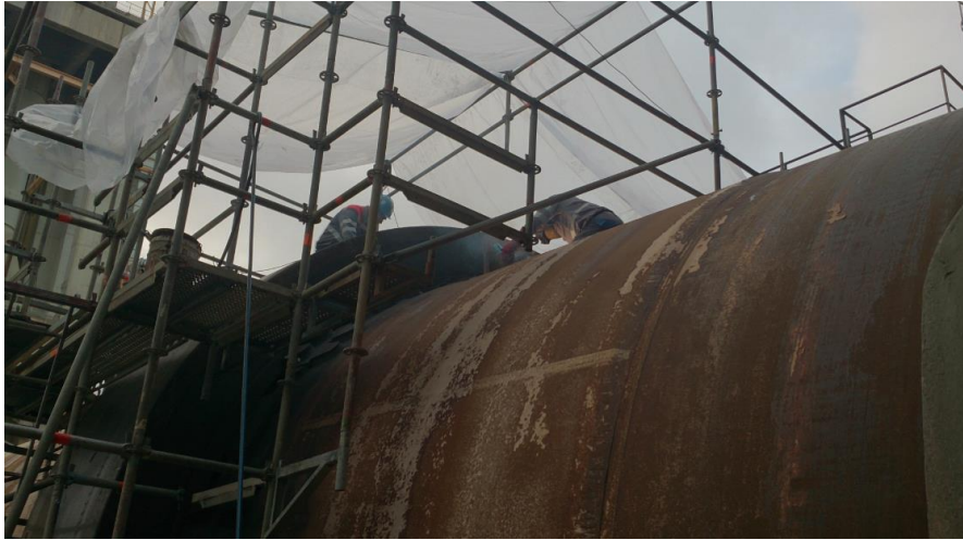
Figura 61: Realização de trabalhos no exterior do forno 3 durante a manutenção anual [Fonte: Cimpor]
