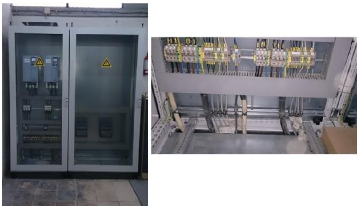
Figura 23: Vista da disposição dos equipamentos dentro do quadro e pormenor das ligações dos cabos de potência e comando
