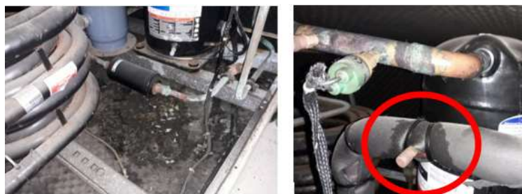
Figura 19 - Indícios de fuga do fluído refrigerante na tubagem do circuito
