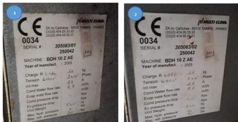
Figura 17 - Chapa característica dos desumidificadores 1 e 2
