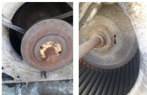
Figura 18 - Ventilador de extração de ar
