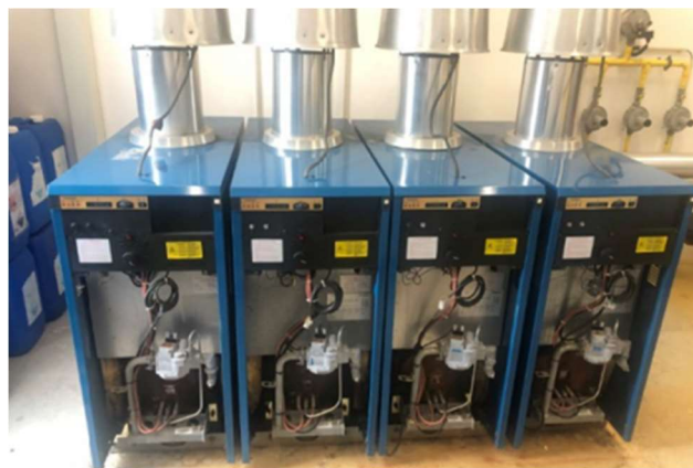
Figura 12 - Caldeiras de chão a gás
