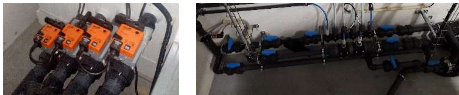
Figura 38 - Electroválvulas e válvulas manuais
