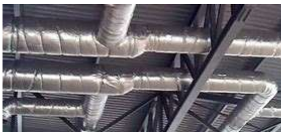
Figura 60 - Condutas de ventilação
