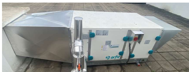
Figura 14 - Unidade de tratamento de ar
