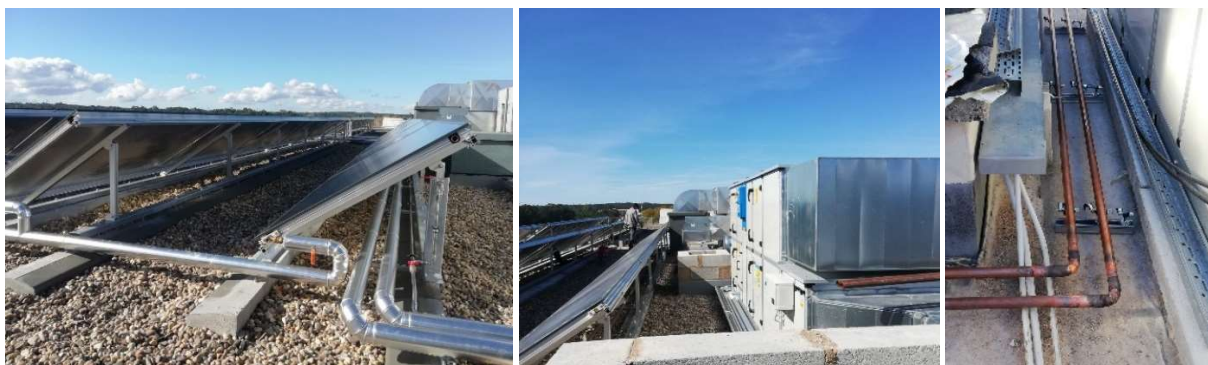
Figura 7 – Instalação de painéis solares térmicos num hotel em Fátima
