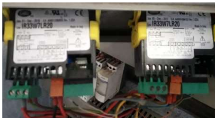
Figura 20 - Controlador de humidade relativa
