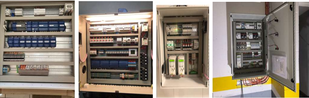
Figura 30 - Quadros elétricos "tipo"
