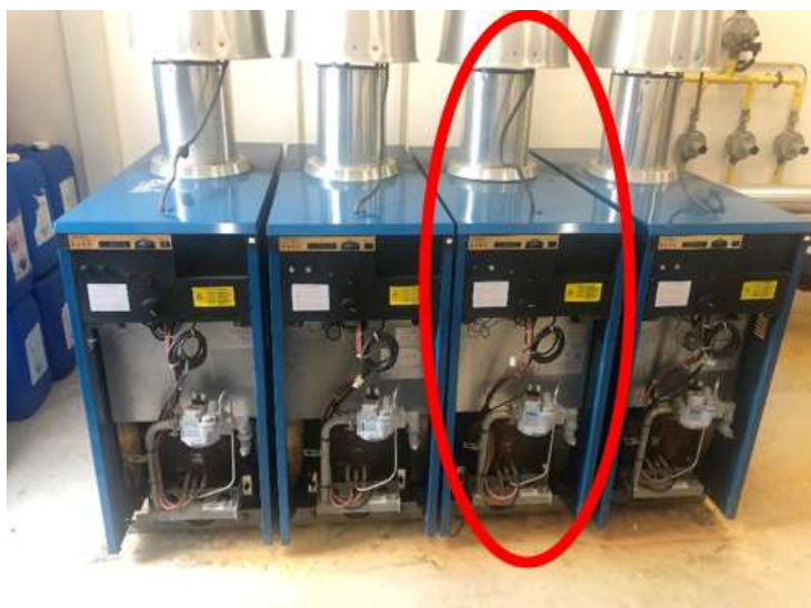
Figura 22 - Grupo térmico com 1 dos módulos em avaria
