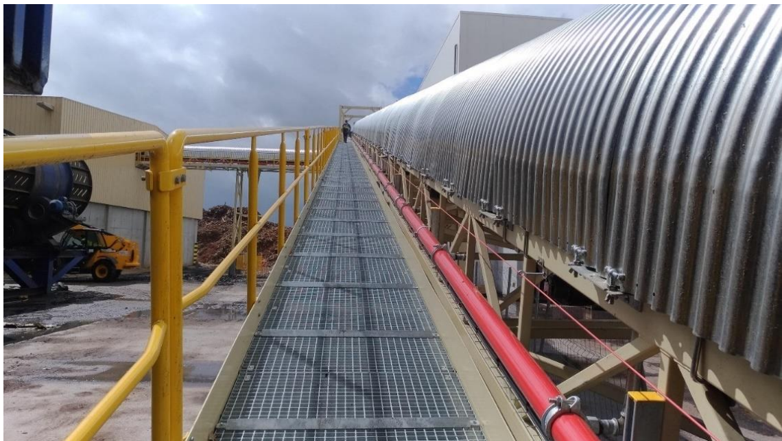
Figura 90 - Visualização de passadiço, guarda corpos e corda de emergência.
