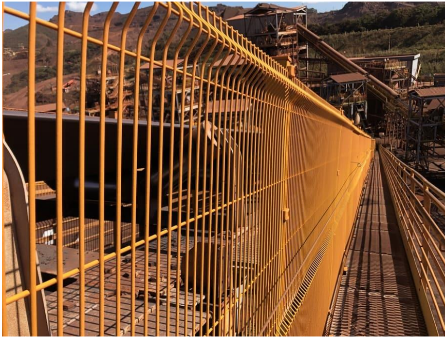
Figura 30 - Gradeamento de proteção utilizado em transportadores (BelgoProtec, 2021).
