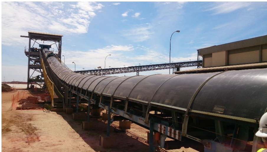
Figura 28 - Exemplo de transportador com coberturas de proteção (Tecnoflex, 2021).
