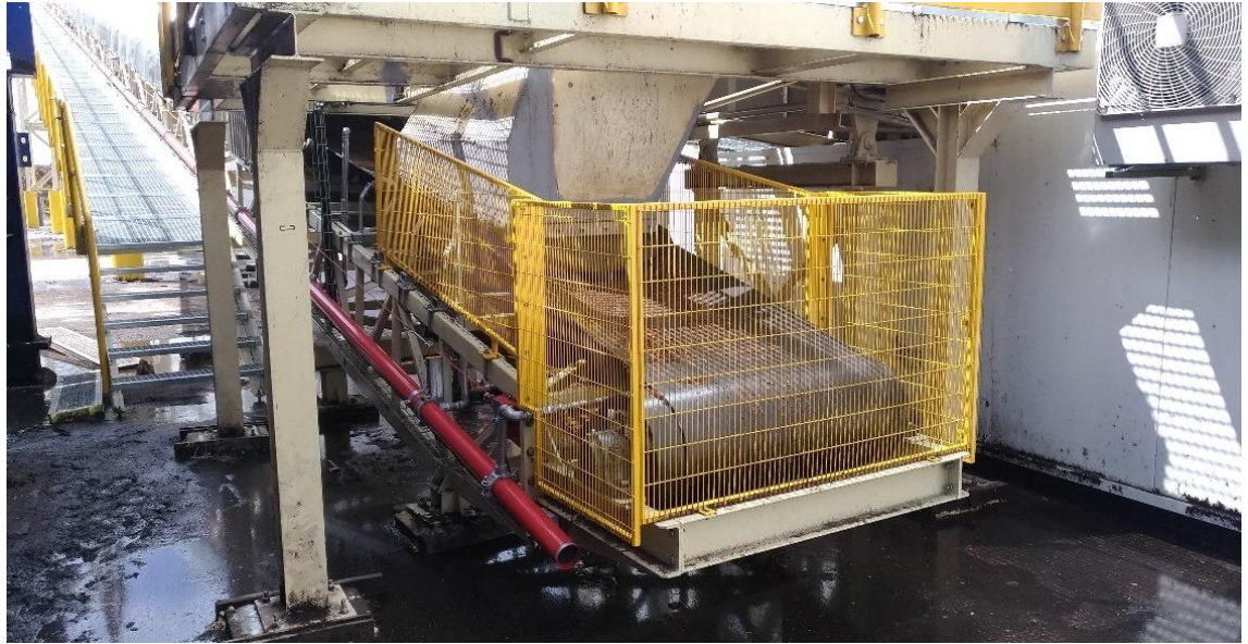
Figura 89 - Zona de transferência de material para o transportador nº1.
