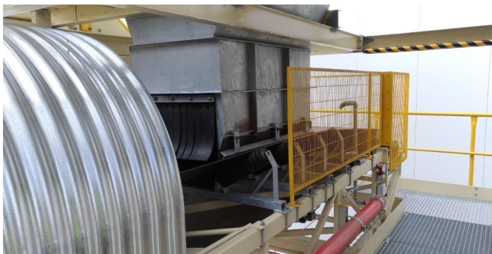
Figura 92 - Zona de carregamento de material no transportador nº2.
