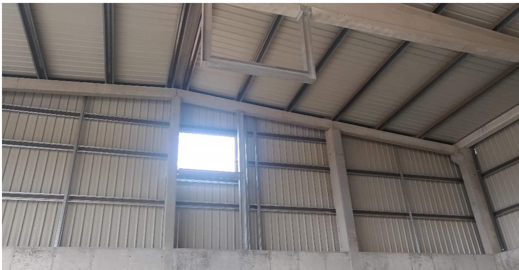
Figura 35 - Zona de entrada do transportador no armazém.
