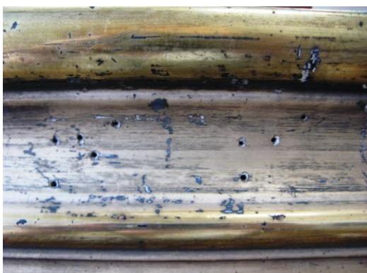
Figura 46 – Local da moldura onde provavelmente esteve algum tipo de placa de identificação.
