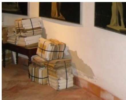
Figura 11 – Aspeto das paredes e do chão da reserva da ANBA.
