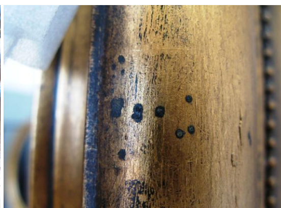
Figura 96 – Superfície metálica salpicada de manchas negras.
