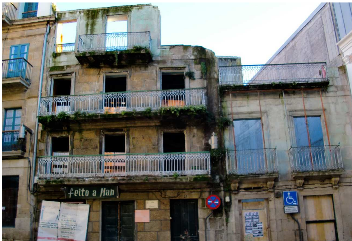
Fig. 4.5.1.13. Edificación en avanzado estado de degradación y abandono en la calle Real.
