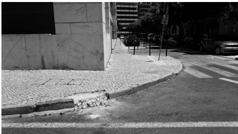
Figura 45 | Falta de manutenção
