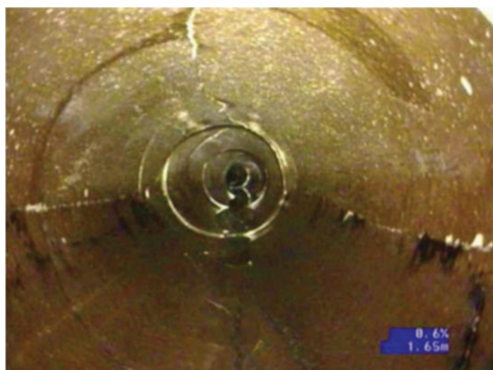
Foto n.º 34 - Patologia identificada: Fissuras reticulares
