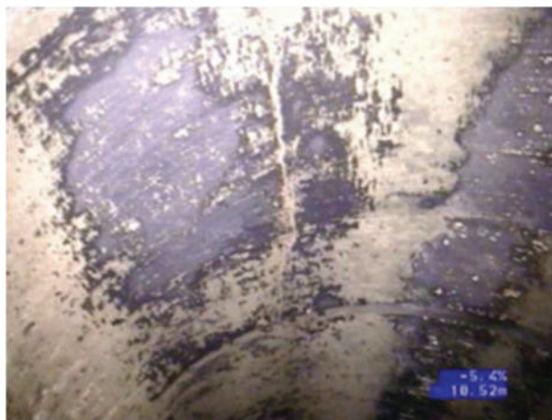
Foto n.º 35 - Patologia identificada: Fissura longitudinal
