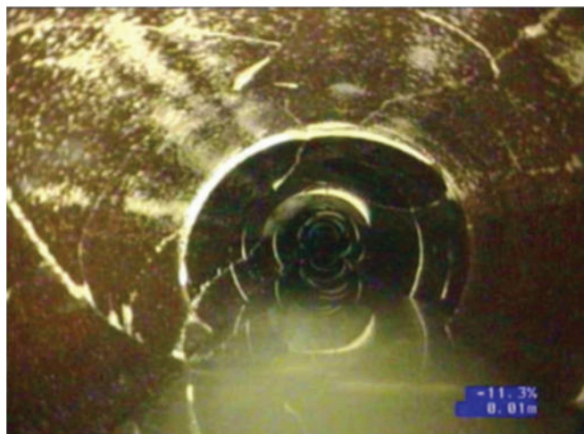
Foto n.º 29 - Patologia identificada: Fissuras de grandes dimensões multidirecionais e deformação com deslocação de secções partidas
