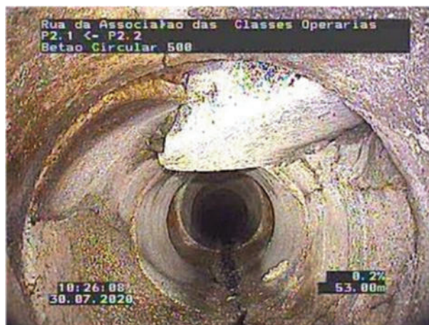
Foto n.º 6 - Anomalia junto à caixa P2.2
