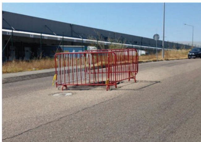
Foto n.º 4 - Abatimento no pavimento, sobre o traçado da tubagem e junto a caixa de visita P8
