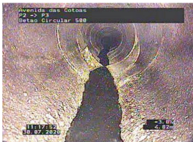
Foto n.º 7 - Manilhas sem fundo no Troço P2 – P3
