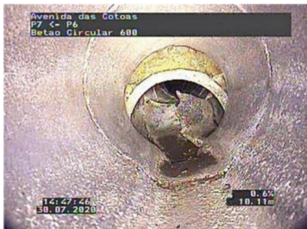
Foto n.º 11 - Tubagem colapsada P7 – P6
