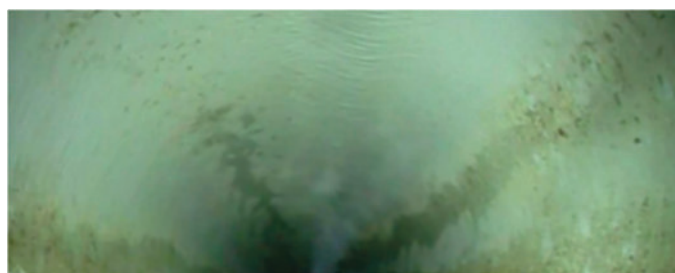
Foto n.º 31 - Patologia identificada: Deformação acentuada
