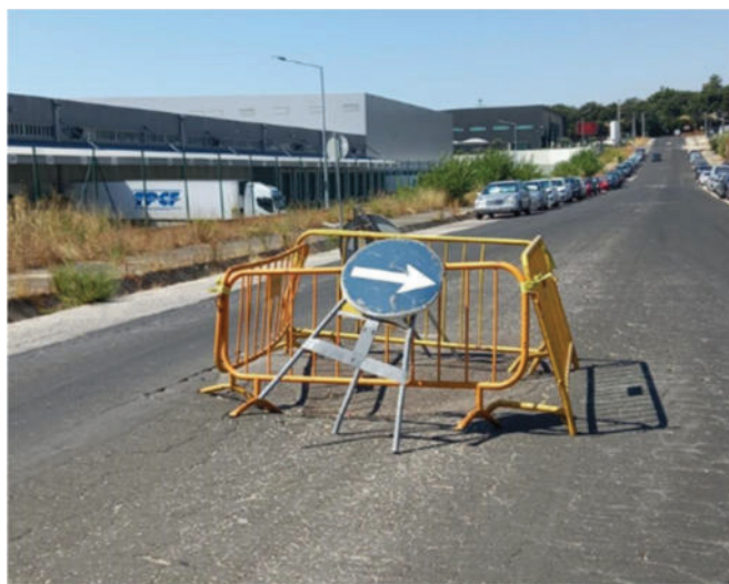
Foto n.º 5 - Abatimento no pavimento coincidente com traçado da tubagem (Troço P6 – P7).
