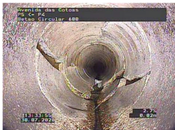
Foto n.º 8 - Manilhas partidas no troço P4 – P5
