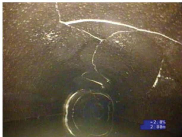
Foto n.º 30 - Patologia identificada: Fissuras reticulares
