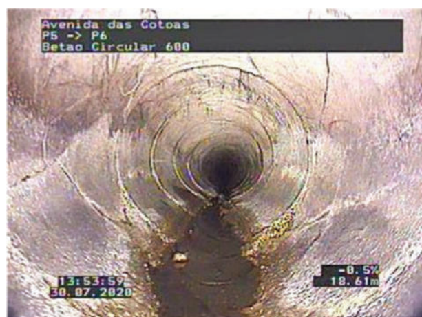
Foto n.º 9 - Manilhas partidas no Troço P5 – P6
