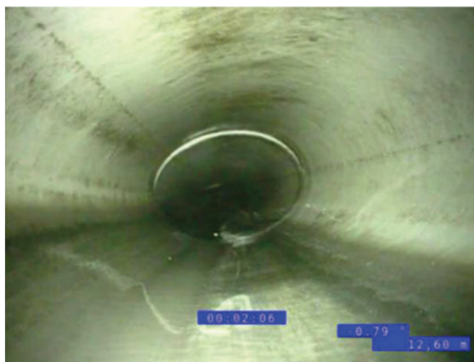
Foto n.º 33 - Patologia identificada: Ovalização muito acentuada
