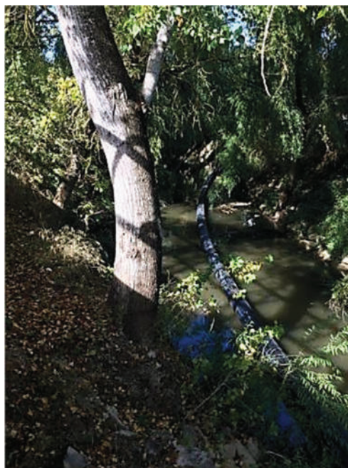
Foto n.º 56 - Coletor PEAD sobre o rio
