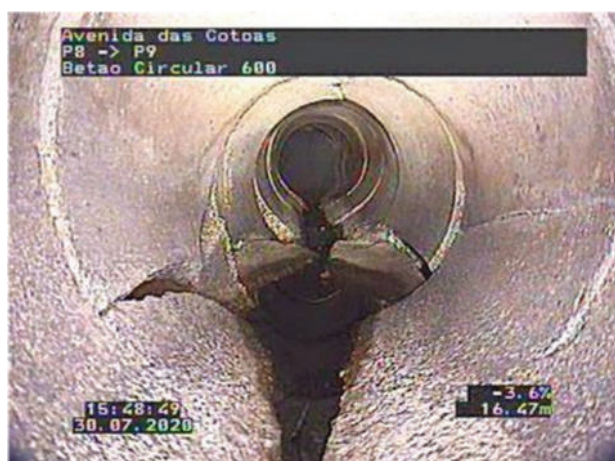
Foto n.º 12 - Ausência de fundo em tubagem no Troço P8 – P9
