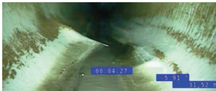
Foto n.º 32 - Patologia identificada: Deformação acentuada
