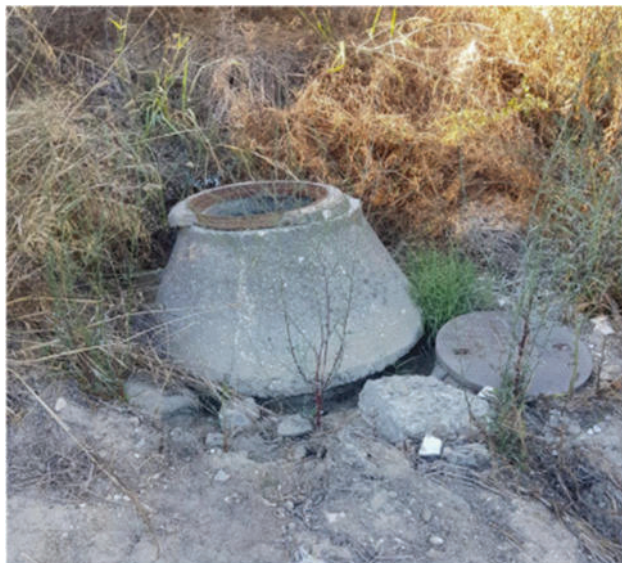
Foto n.º 13 - Caixa P11, evidenciando sinais de ocorrência de transbordo
