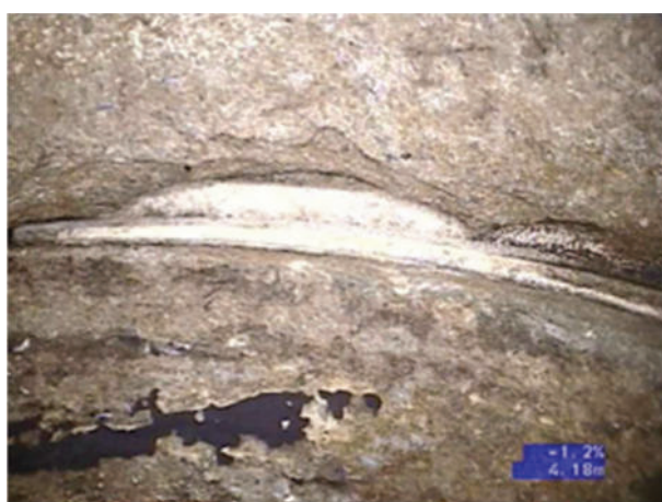
Foto n.º 37 - Patologia identificada: Faltam secções na junta
