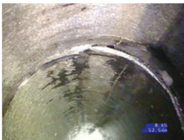
Foto n.º 36 - Patologia identificada: Fissuras reticulares
