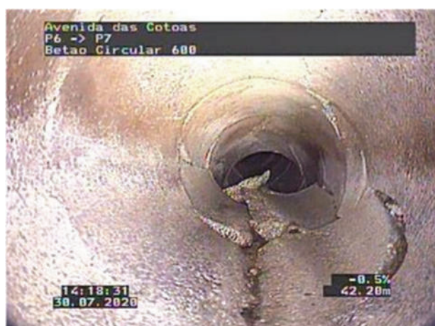
Foto n.º 10 - Tubagem parcialmente colapsada no Troço P6 – P7
