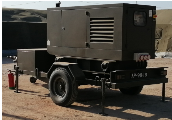
Figura 2.1: Gerador elétrico utilizado pela Marinha Portuguesa.
