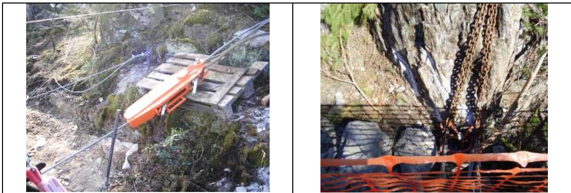
Figura 2 - Linha de vida da giratória robotizada Figura 3 - Ancoragem da giratória robotizada
