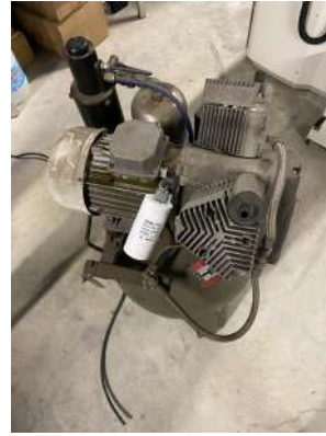
Figura 3.28: Compressor de ar.
