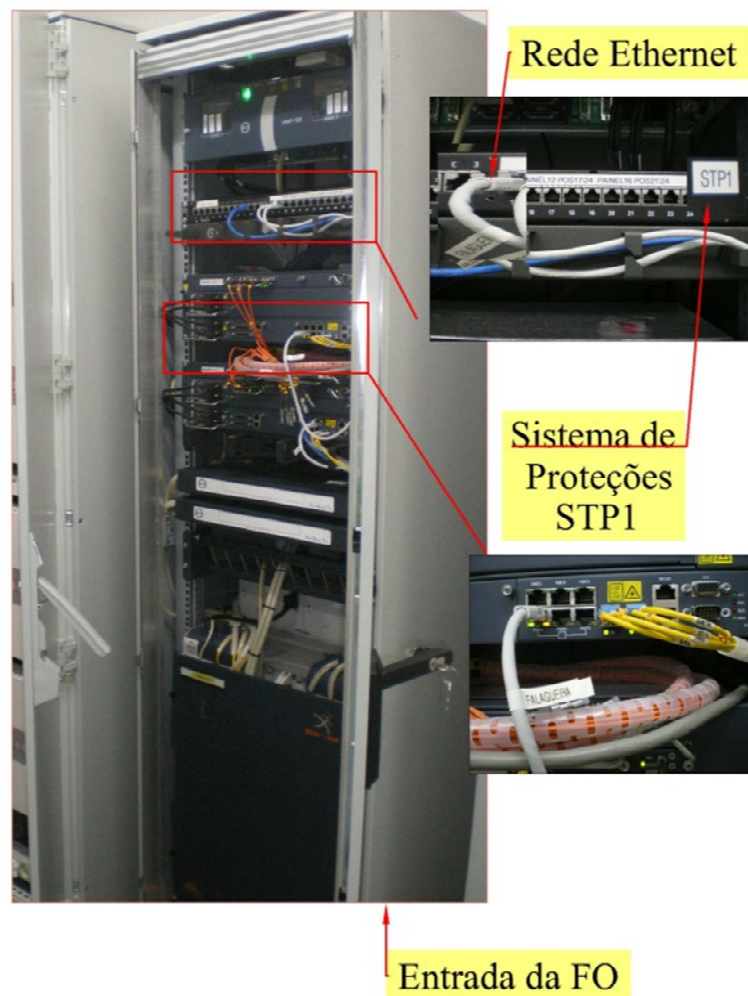
Figura 2-20 – Sistema de Telecomunicações SCC- SDH
