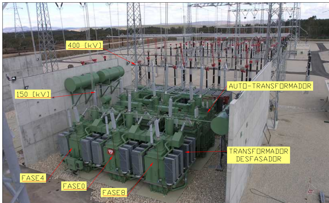
Figura 2-9 – Auto-Transformador Desfasador ATD na SFR
