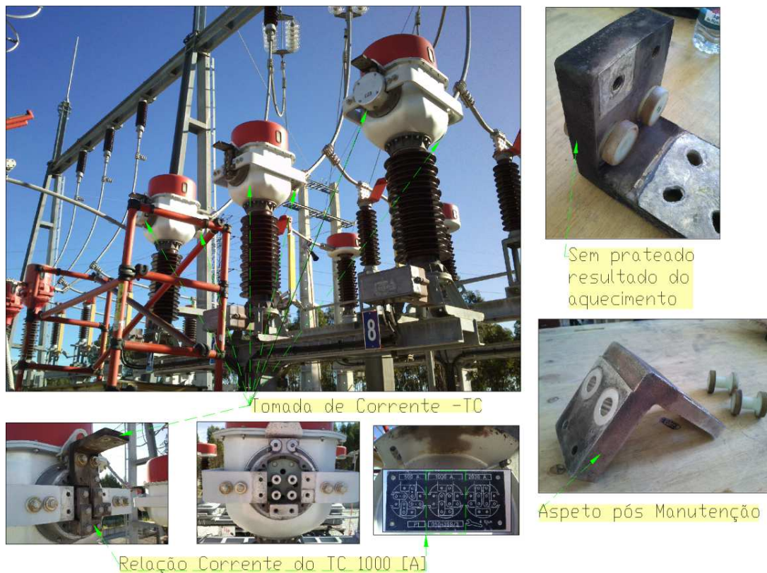
Figura 6-4 – TC Sobreaquecimento da tomada de Corrente (27/08/2015)
