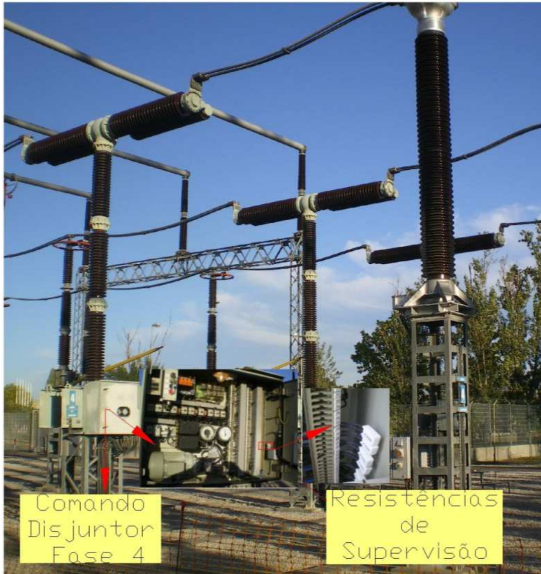
Figura 6-13 –Disjuntor-Q51, Supervisão BD1, BD2 07/04/2015
