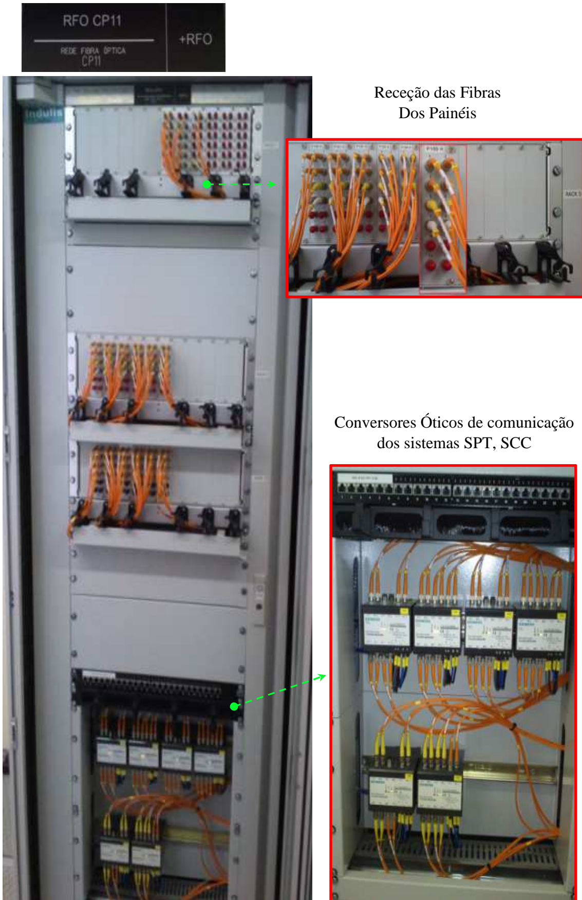
Figura 2-23 – Repartidor fibra ótica RFO, repartidor, SFR Julho de 2105
