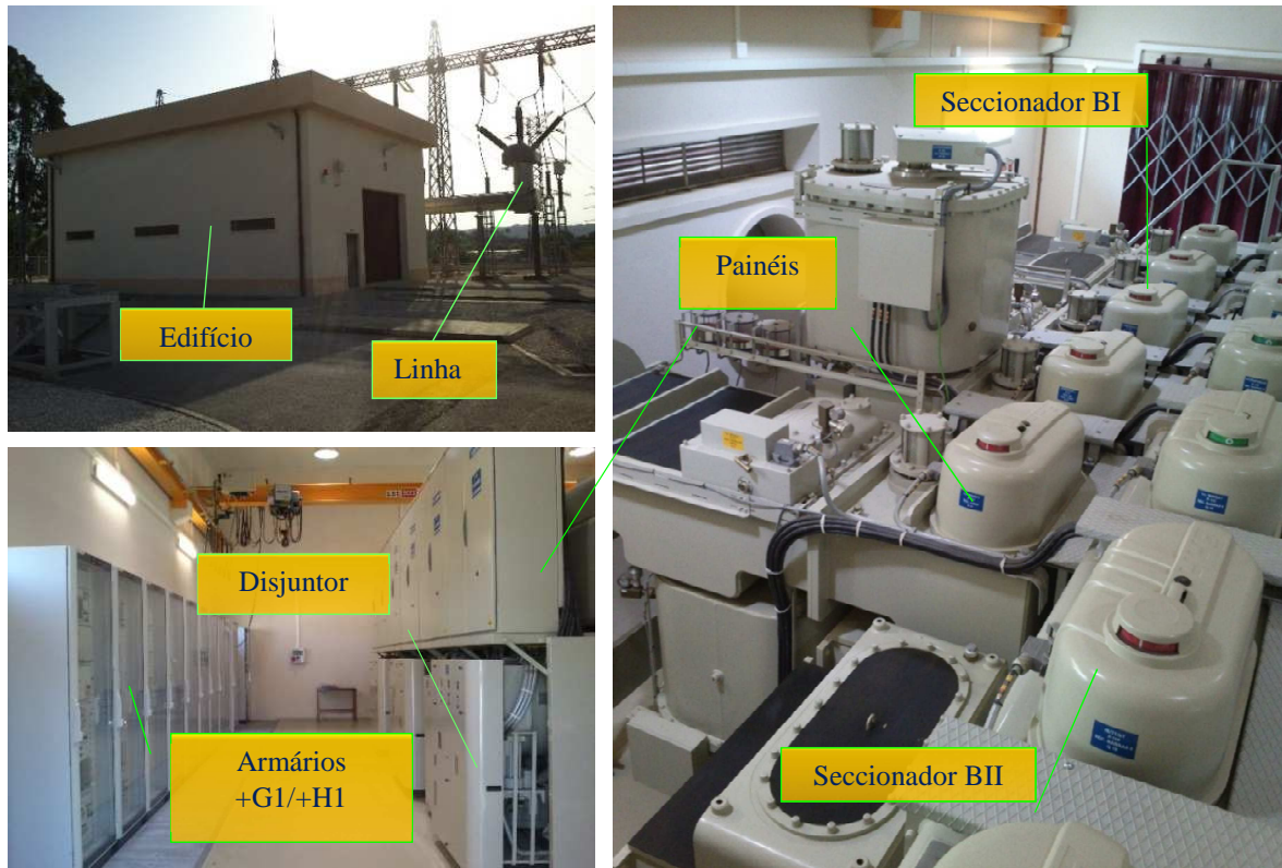
Figura 2-3 – Posto Blindado Subestação Zêzere (SZR), Janeiro de 2015
