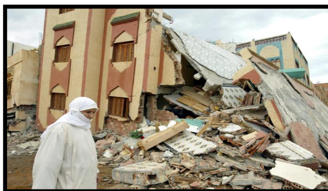
Figura 2 - Edifício colapsado em Imzouren no nordeste de Marrocos [17]
