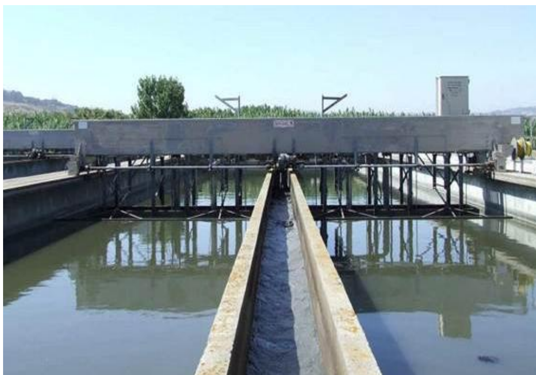
Figura 12 - Canais de tratamento de UV's
