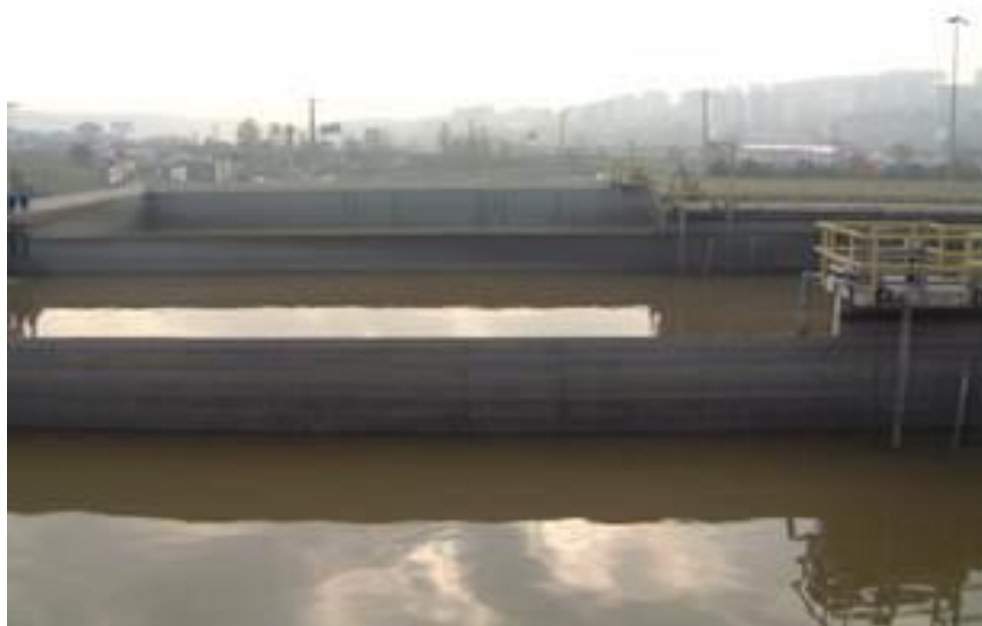
Figura 7 – Tanques de Equalização (1)
