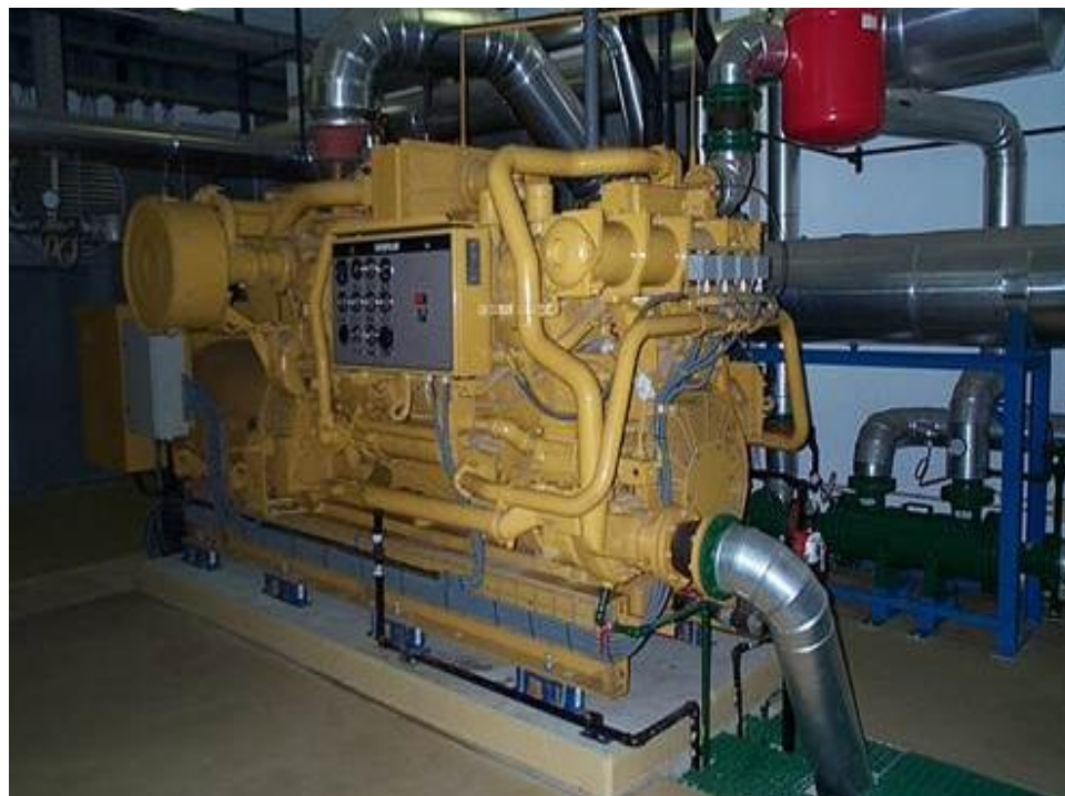
Figura 10 – Motor da Cogeração
