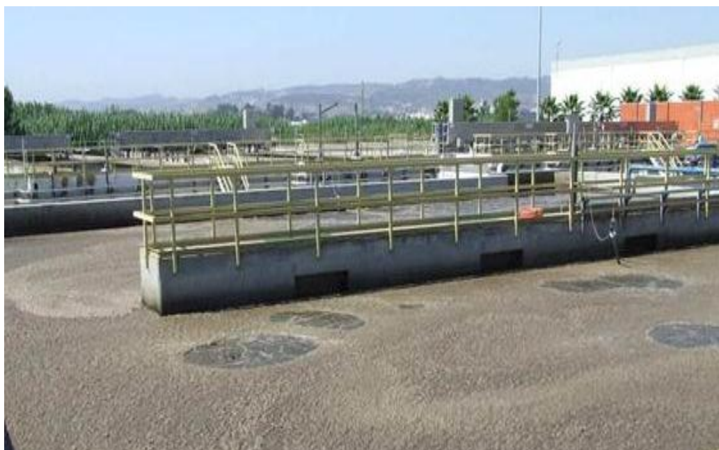
Figura 6 – Tanques de Arejamento
