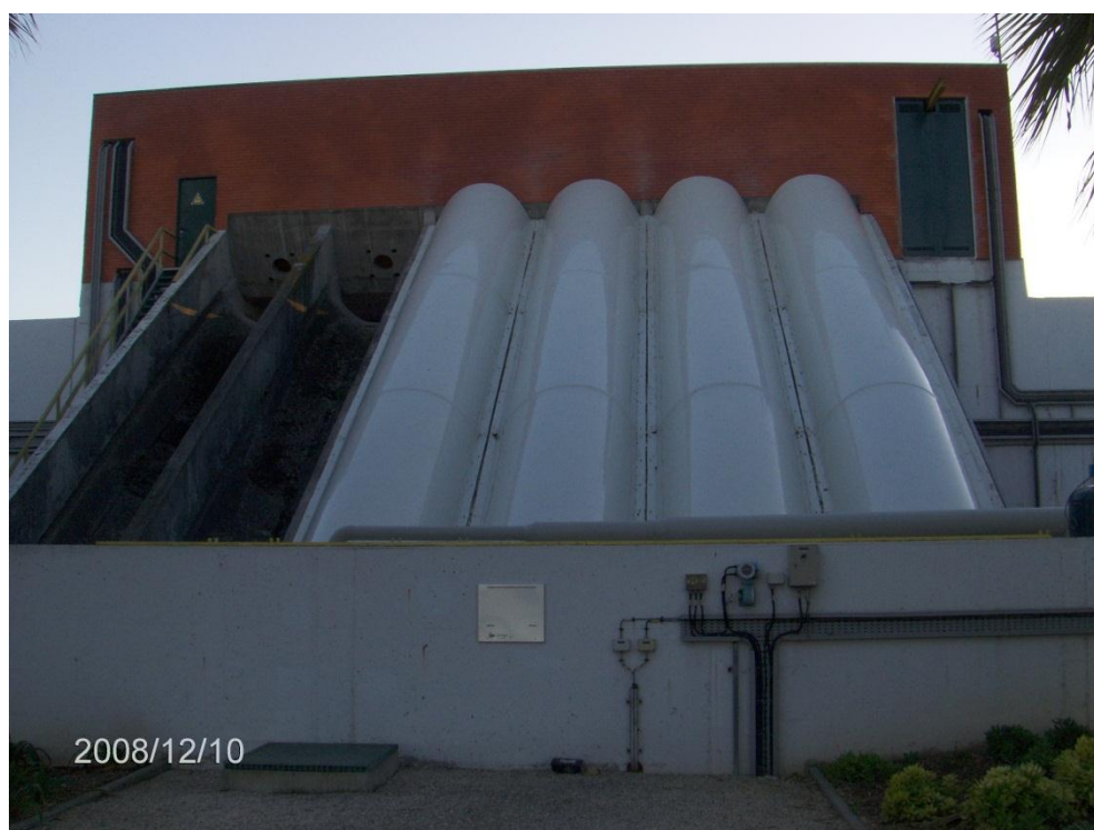
Figura 3 – Vista Exterior da Gradagem Mecânica
