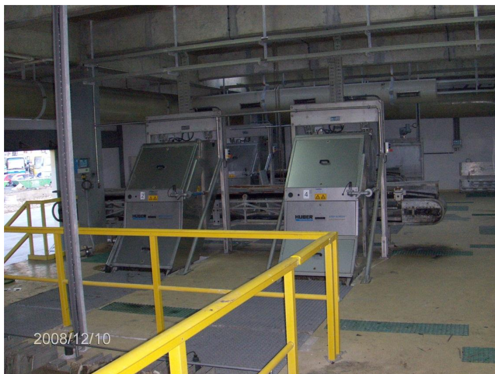
Figura 2 – Sala da Gradagem Mecânica
