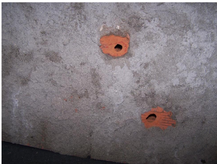
Imagem 2 - Impactos de munições 5,56 mm e 7,62 mm, respectivamente, numa parede de tijolo de aproximadamente 10 cm. (Foto Tirada pelo Autor) Ambos os calibres perfuraram devido aos disparos terem sido efectuados a distâncias muito curtas.
