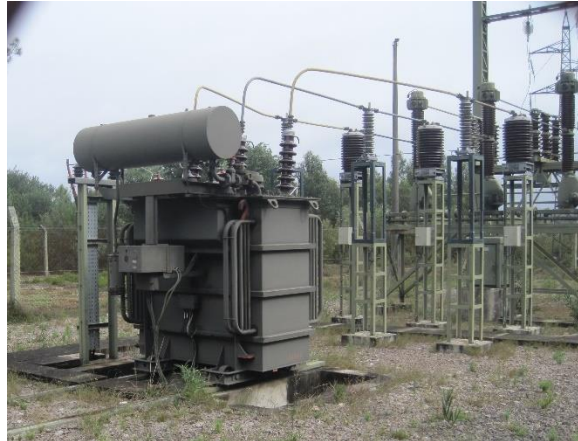
Figura 12 – Subestação de 400kV , Transformador 60kV/15kV, 860kVA (AM1)
