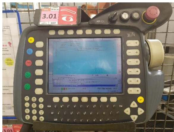
Figura 103 - Consola do controlador do robô.
