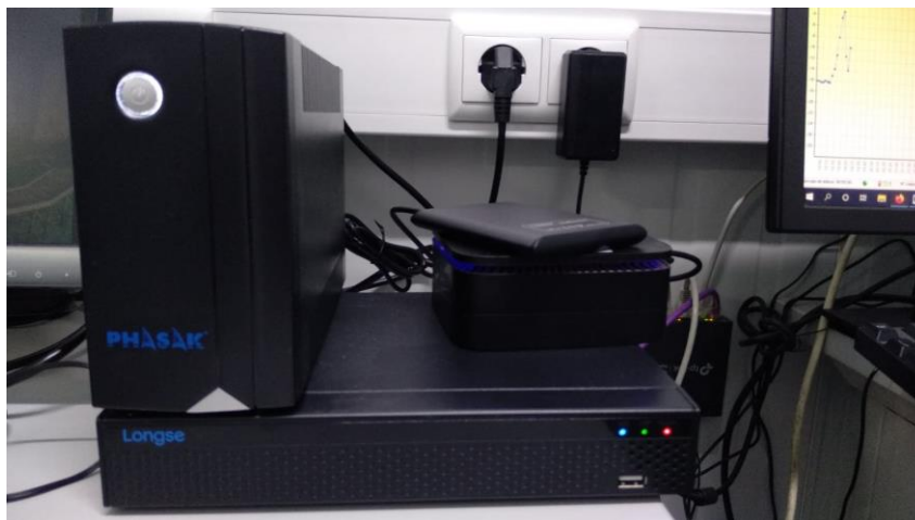
Figura 3 - Sistema CCTV com UPS
