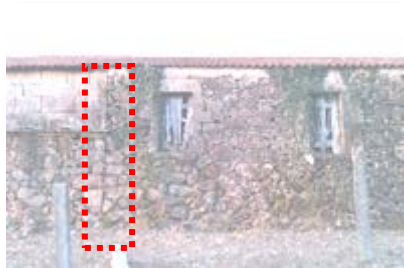
Fig. 100 – Junta na fachada sul
