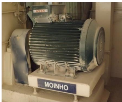
Figura 4: Moinho existente nas instalações
