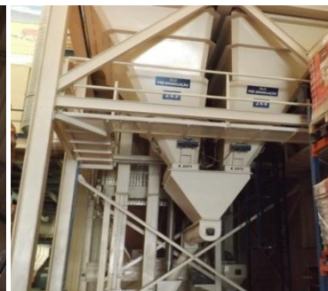
Figura 6: Silos de pré-granulação
