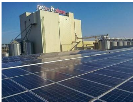
Figura 21: Painéis fotovoltaicos presentes na Rações Zêzere, S.A.
