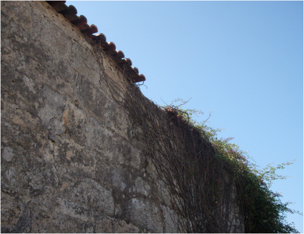
Q8 COBERTURA DANIFICADA
