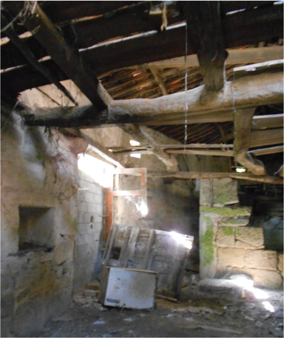
FIG. 57 DEPENDÊNCIAS PARA AGRICULTURA/PECUÁRIA — ESTRUTURA DO PISO SUPERIOR (EM RUÍNA)
