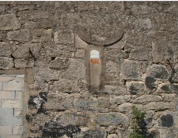
Q5 INDÍCIO DE REMOÇÃO DE ELEMENTO DA FACHADA
