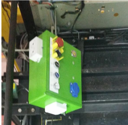
Figura 28 - Consola de comando no cimo da cabina
