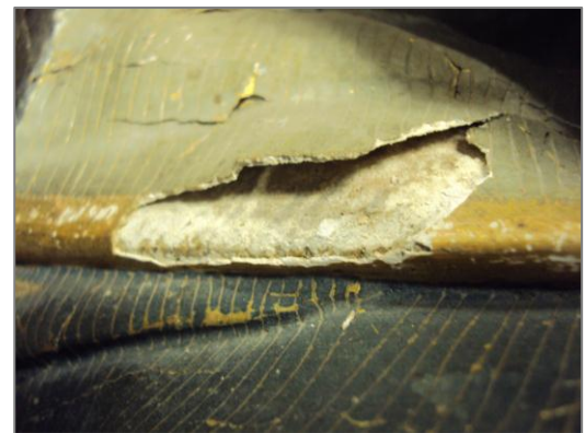
Fig.81 Destacamento acentuado no interior do manto.
