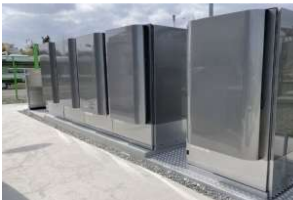
Figura 20: Combinação de eletrolisadores de óxidos sólidos da marca Bloom Energy
