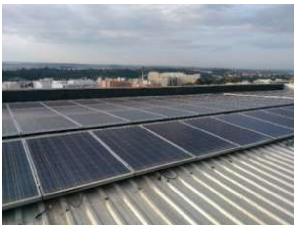
Figura 5. 25 – Painéis fotovoltaicos em cobertura painel sandwich
