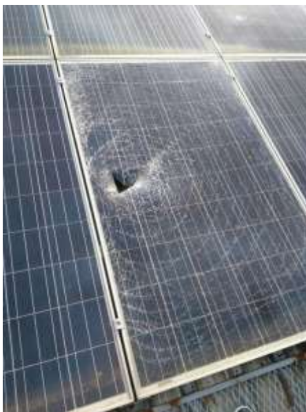
Figura 6.45 – Painel fotovoltaico danificado
