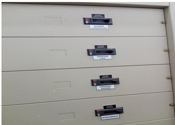
Figura 105 - Identificação do quadro elétrico
