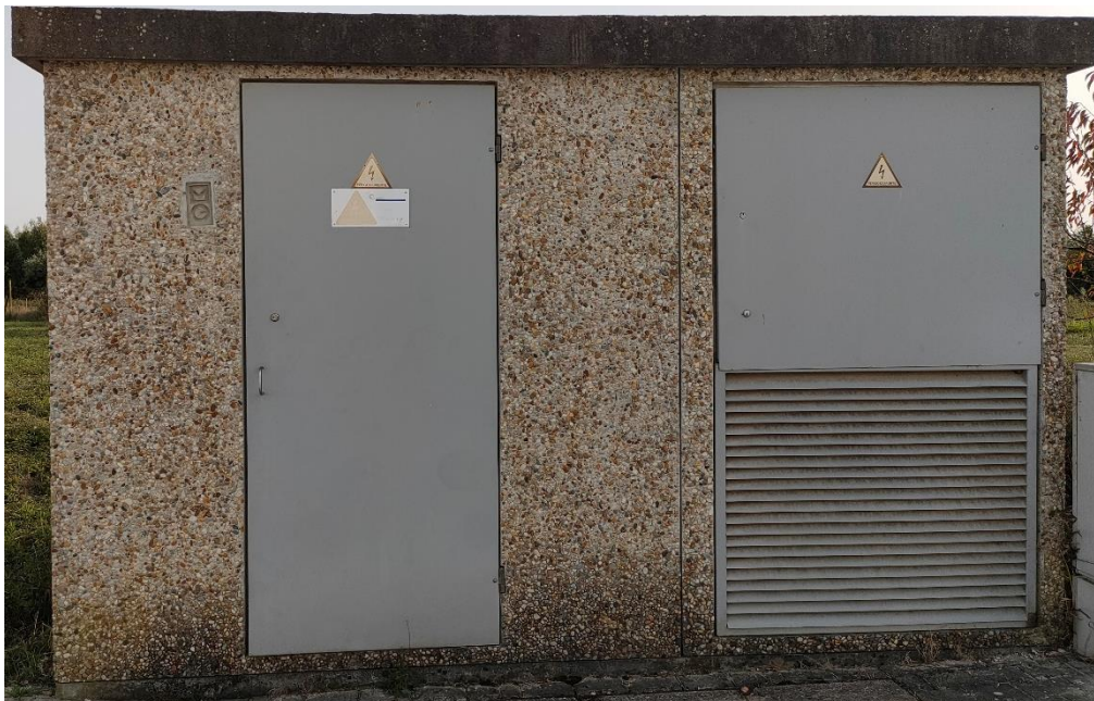
Figura 2 - Posto de transformação e distribuição em cabine com alimentação subterrânea
