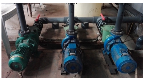
Figura 2.24 – Sistema de bombagem
