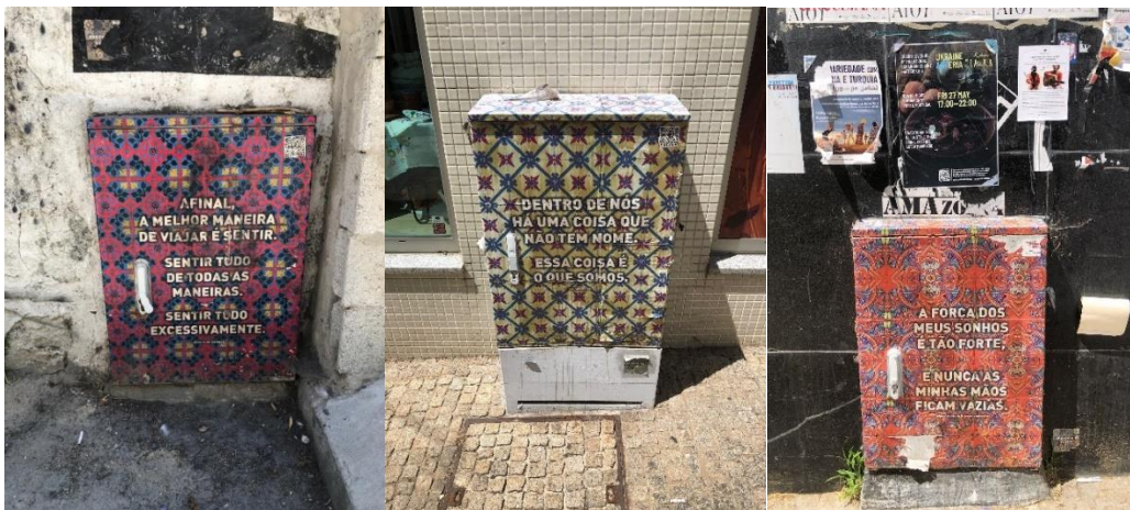
FIGURA 53: CAIXAS DE ELETRICIDADE NA RUA MIGUEL BOMBARDA FONTE: PRÓPRIA (JULHO DE 2023)
