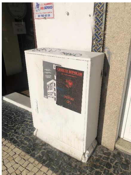
FIGURA 41: CAIXA DE ELETRICIDADE, RUA DE CEDOFEITA FONTE: PRÓPRIA (SETEMBRO DE 2023)
