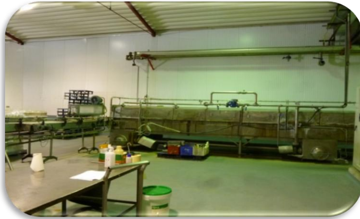
Figura 12: Túnel de pasteurização e arrefecimento.
