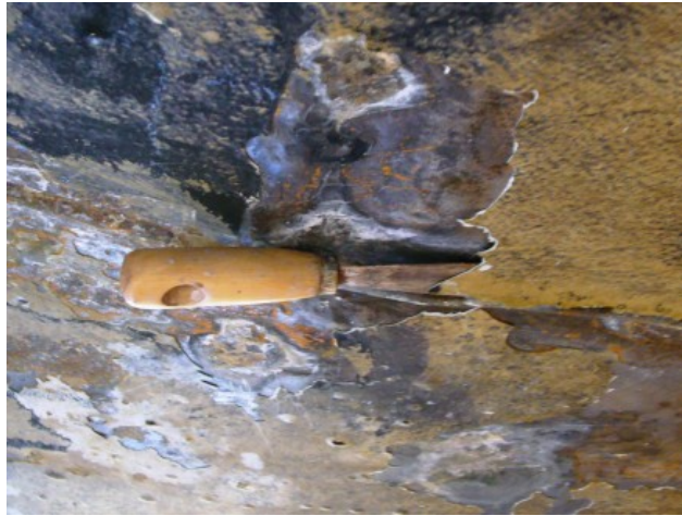
Fig.13. Fundo chato de um navio de carga. Superfície em muito mau estado de aderência e corrosão, comprometendo sériamente os trabalhos no caso de não se optar por um tratamento adequado por decapagem. Fonte: Foto do autor.
