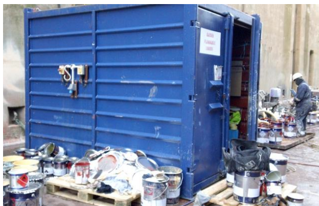
Fig.70. Contentor aquecido eléctricamente, para armazenamento nocturno e estabilização de temperatura de “Hempasil Nexus”, requisitado para uma docagem durante o período de inverno de 2014.
