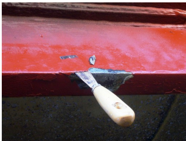
Fig.14. Robalete. Desprendimento total das películas de tinta por má aderência ao substrato. Esta é uma situação frequente quando se procede à substituição total ou parcial da "viga" do robalete, não sendo possível por motivos operacionais, recorrer a decapagem, sujeitando-se a aplicação de tinta a um simples pré tratamento mecânico manual da superfície.
