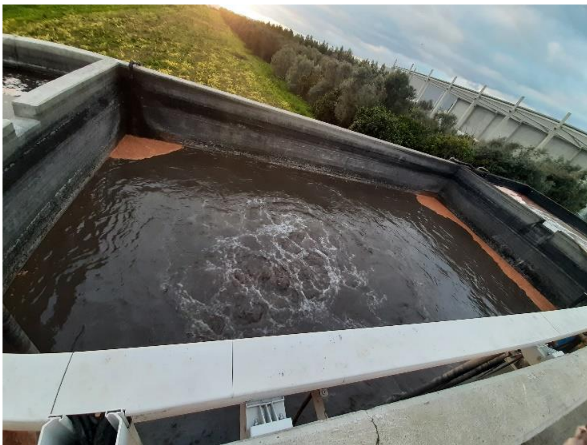
Figura 13: Tanque de equalização
