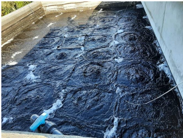
Figura 15: Reator biológico SBR em fase de arejamento
