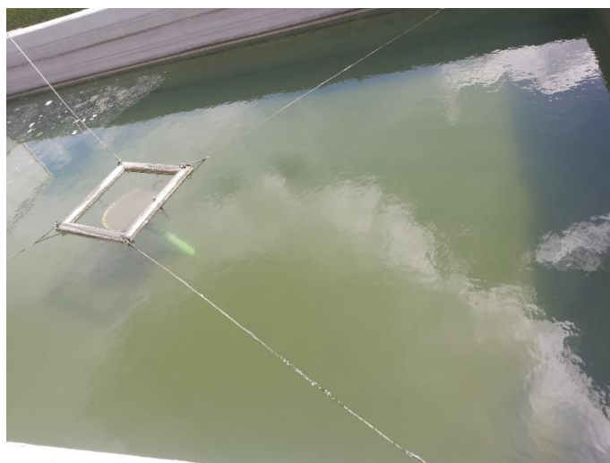
Figura 17: Cone flutuante do SBR para descarga do efluente tratado
