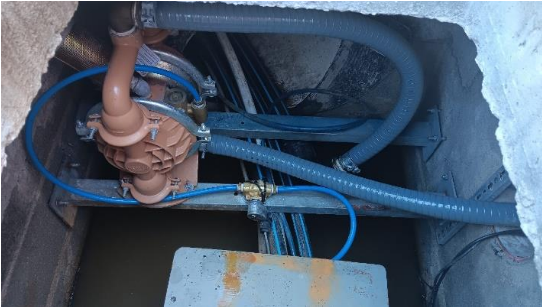
Figura 10.3- Caixa da bomba de águas residuais que fica com água e lixo.
