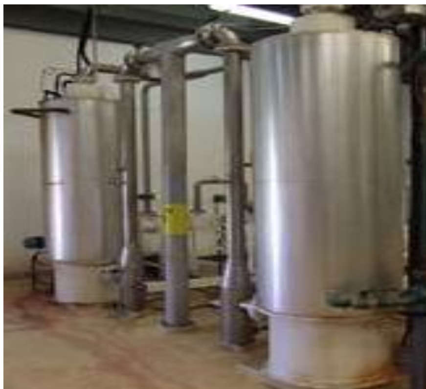
Figura 2 – Sala dos Lavadores de Biogás
