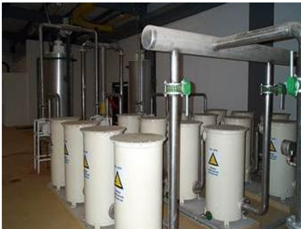
Figura 1 - Sala de Depuradores de Biogás
