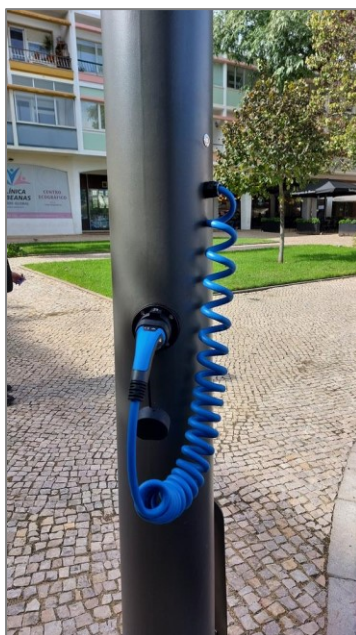
Figura 15 – Carregador para VE instalado num candeeiro de rua proposto pela Galp [42].
