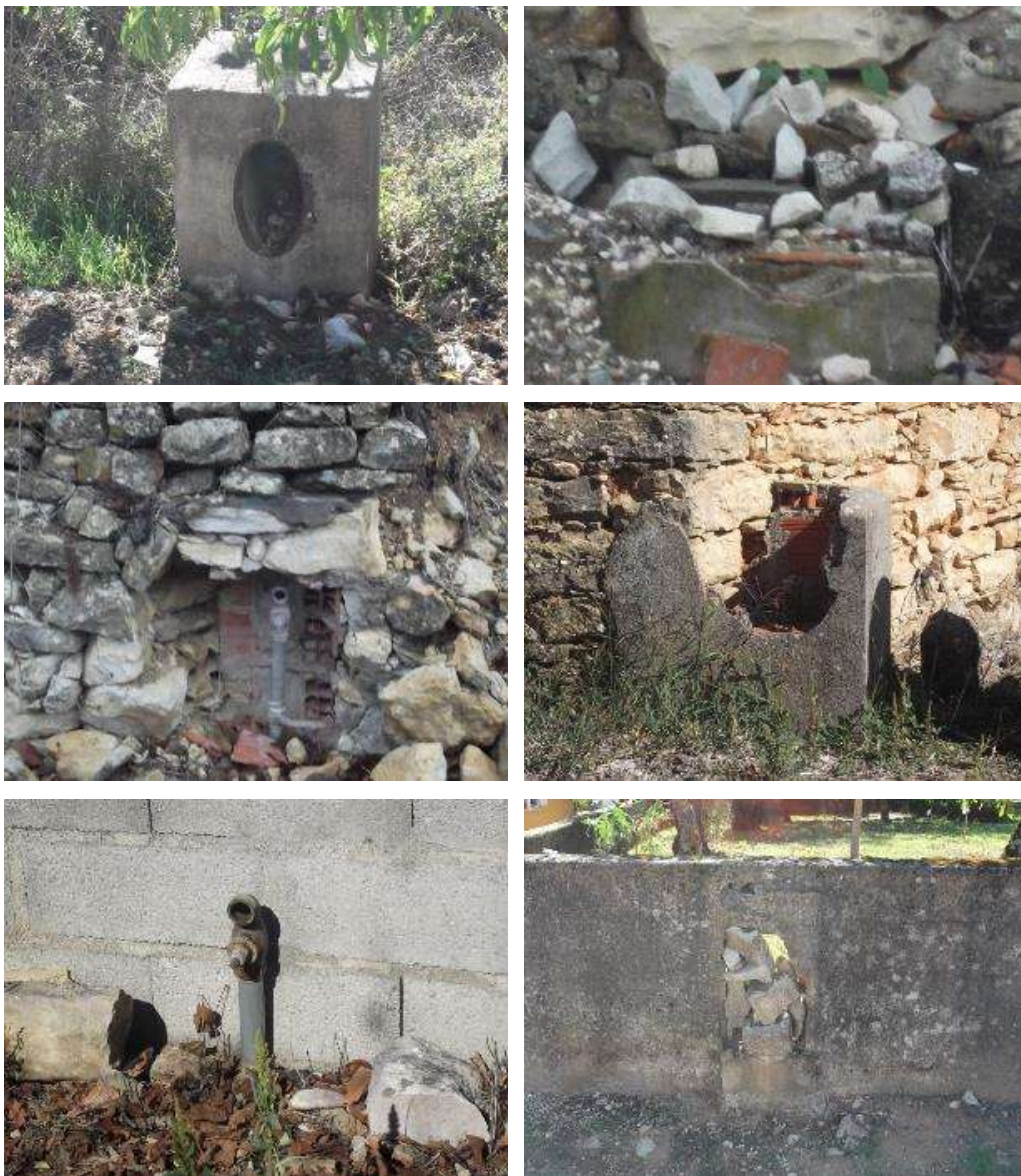
Figura 31 - Fotos de bocas-de-incêndio do subsistema de Chãos
