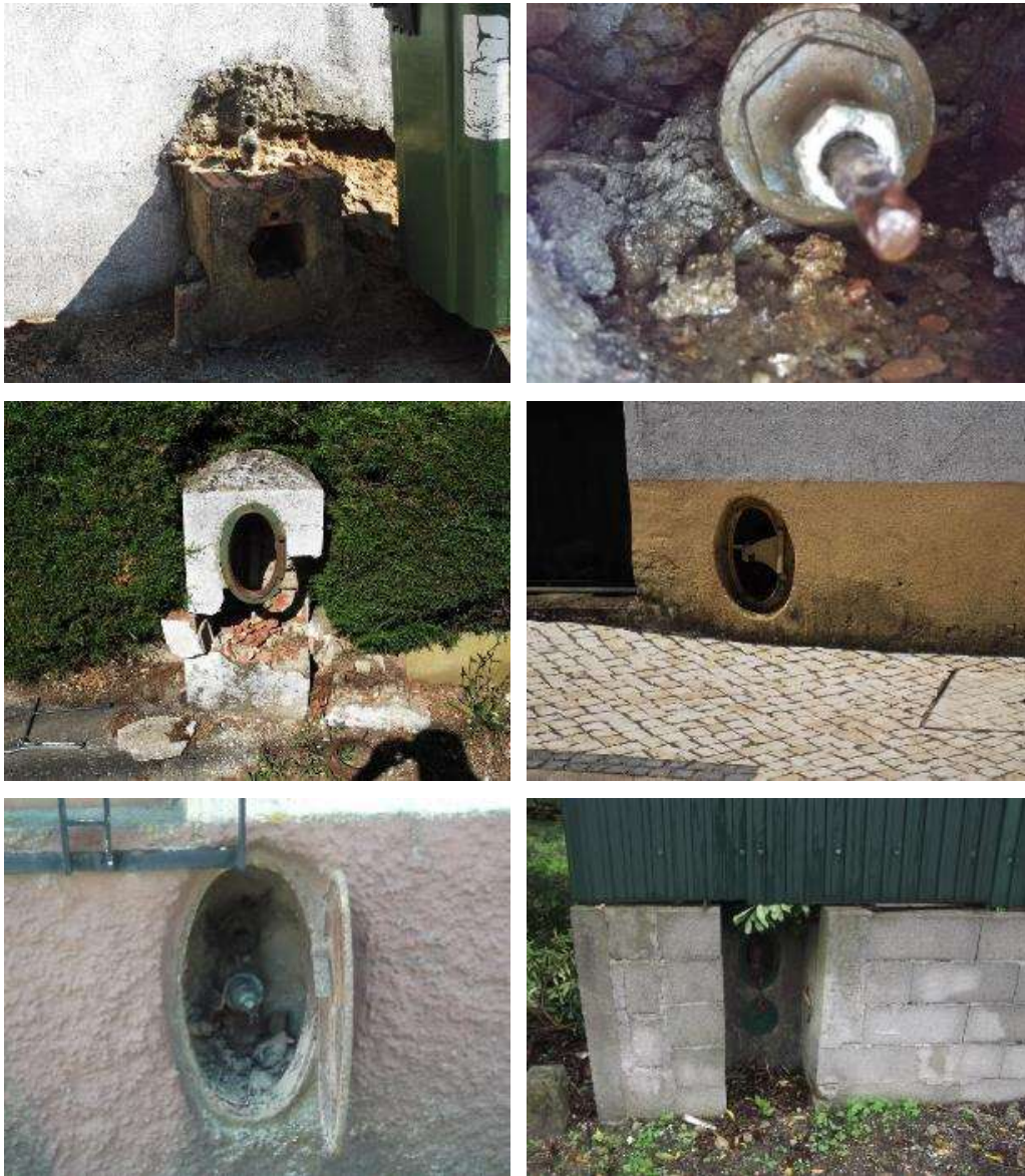
Figura 32 - Fotos de bocas-de-incêndio do subsistema de Ferreira do Zêzere.
