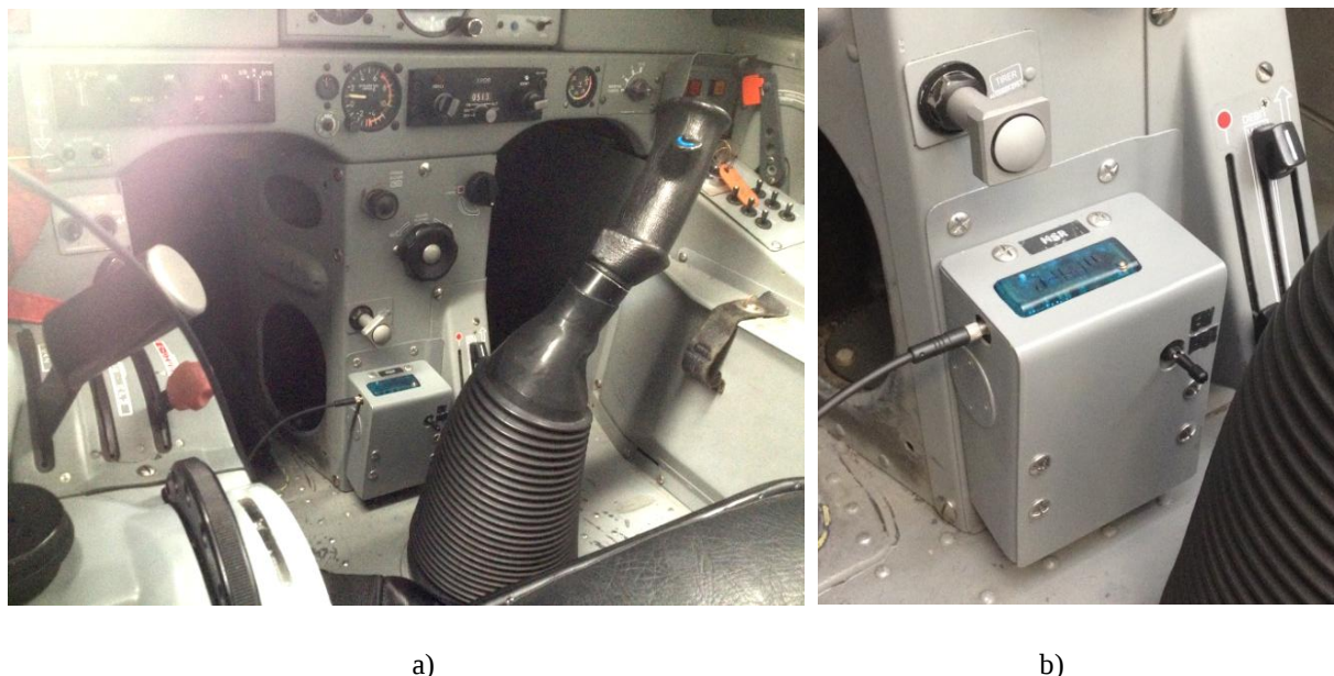
Figura 4.3 – Localização do conjunto, suporte e acelerómetro MSR 165, a) Vista geral, b) Vista pormenorizada
