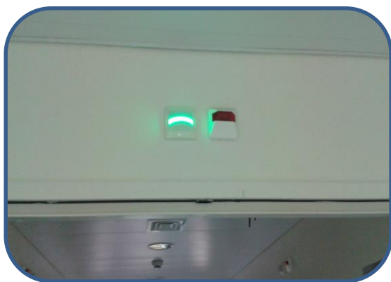
Imagem 7: Luz que indica que o interruptor verde foi acionado.
