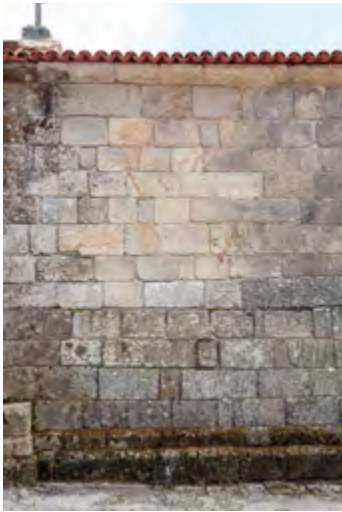
Igreja. Fachada norte. Capela-mor. Pormenor das cicatrizes.
