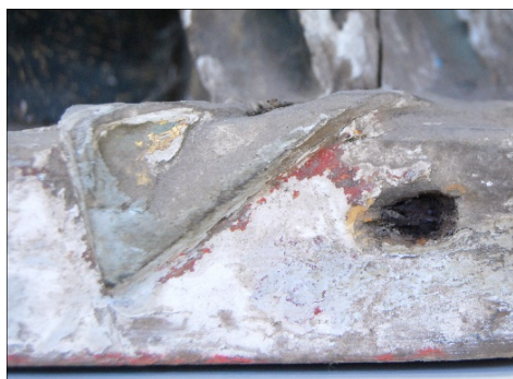
Figura 49. repinte da base sobre a ponta do manto. A. P.
