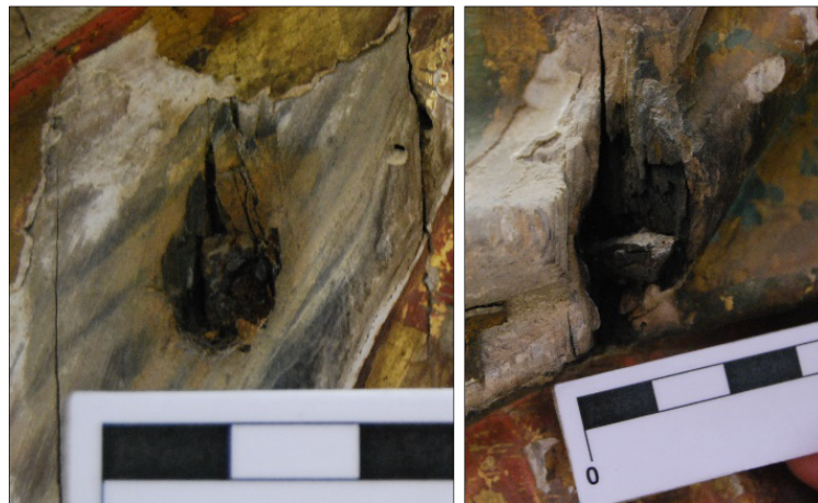
Figura 65 e 66. Exemplos da oxidação de alguns elementos metálicos. A. P.
