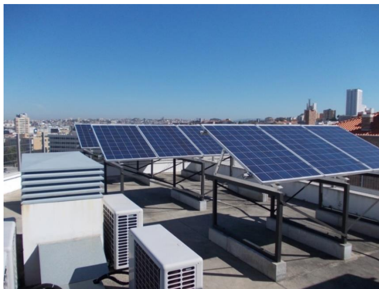
Figura 20 - Painéis fotovoltaicos instalados no ISPGaya.
