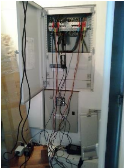
Figura 21- Ligação do analisador de rede ao quadro elétrico do ISPGaya.
