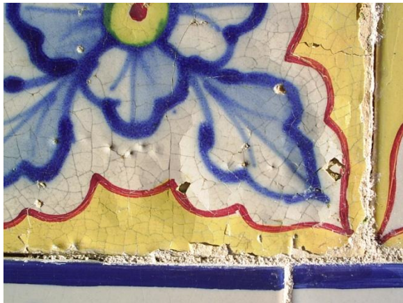
Destacamento e empolamento de vidrado e eflorescências
