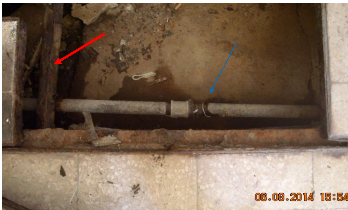
Figura 71: Parte do percurso vertical da tubagem de águas quentes sanitárias (AQS), junto da caldeira.
