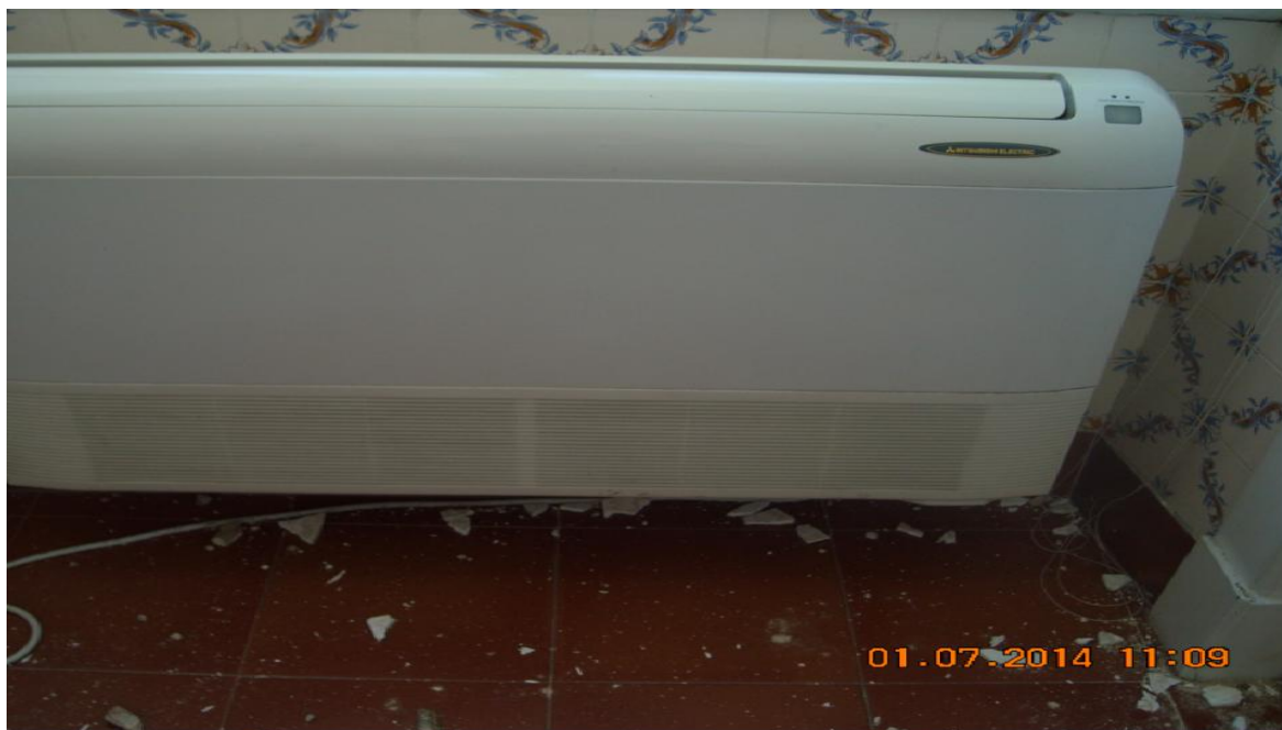
Figura 58: Aspeto de um, dos vários Spliter's instalados no Edifício Administrativo.
