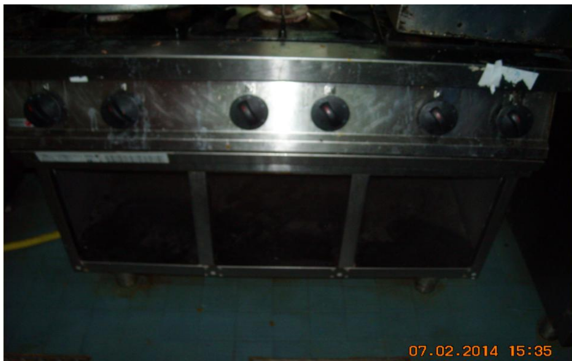
Figura 38: Fogão instalado na cozinha de reclusos. (No sítio do forno existem “buracos”, (espaços vazios).
