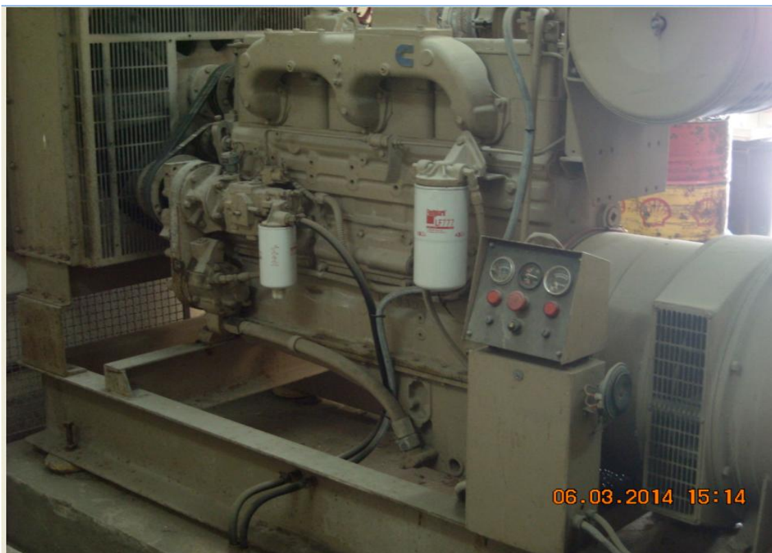
Figura 46: Grupo de Emergência instalado no Posto de Transformação
