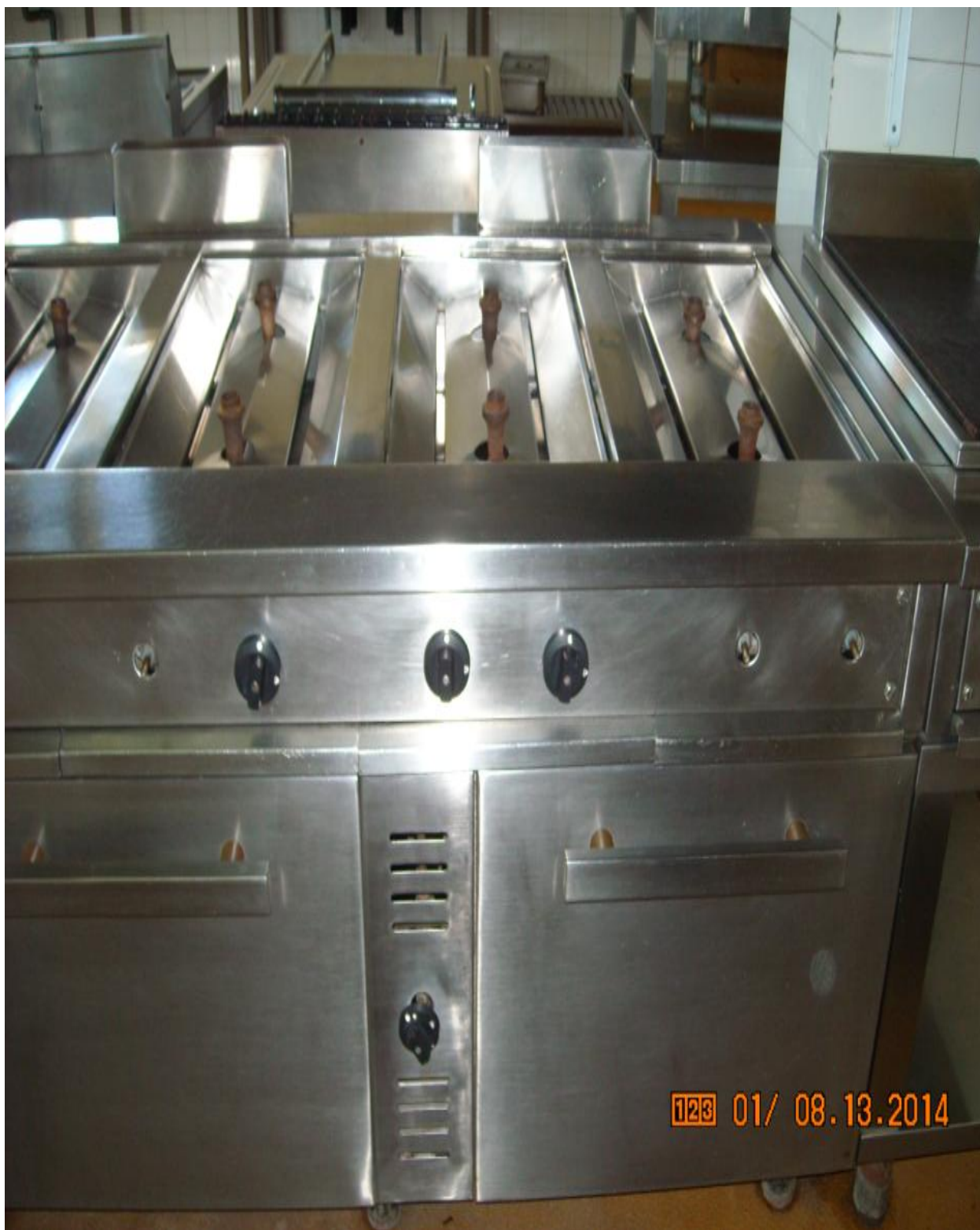
Figura 37: Fogão na cozinha da Ala G- (faltam manípulos e os espalhadores de gás).
