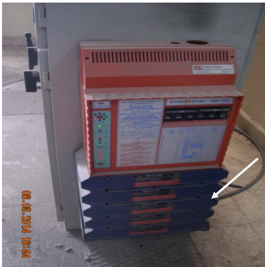
Figura 42: Imagem da bateria de condensadores para correção do fator de potência.
