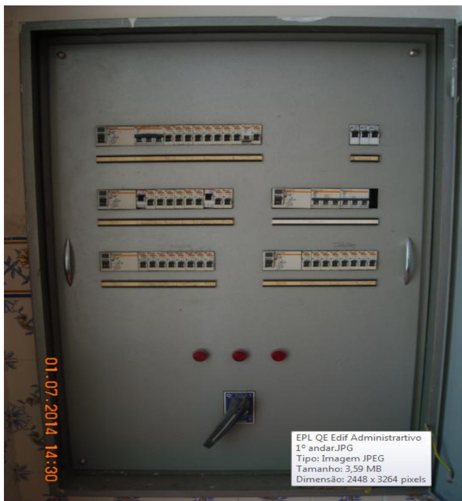
Figura 47: Vista geral de um dos Quadros Elétricos Parciais
