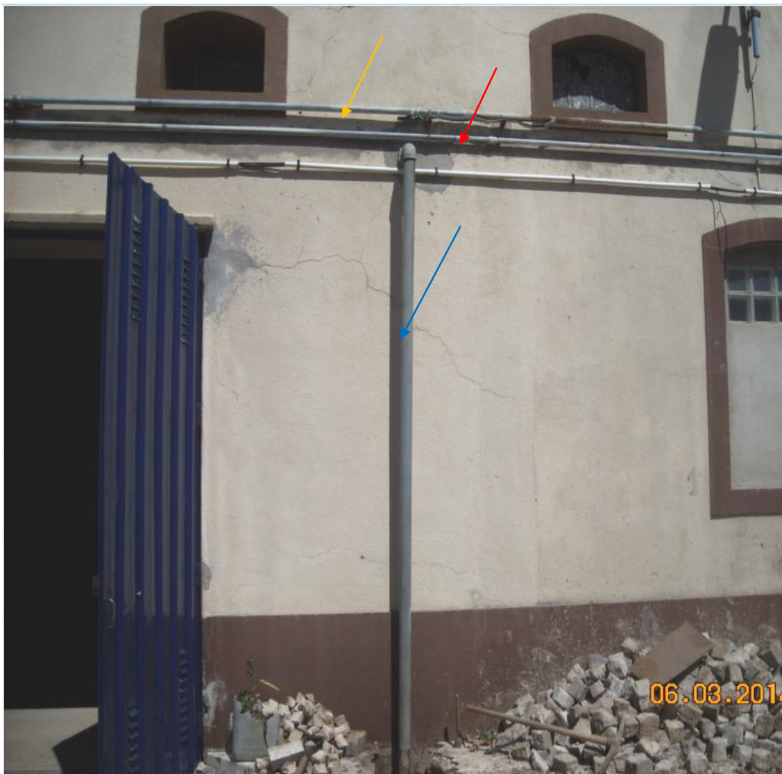
Figura 70: Parte do percurso da tubagem de ida e de retorno de AQS, sem isolamento térmico, no exterior do edifício.
