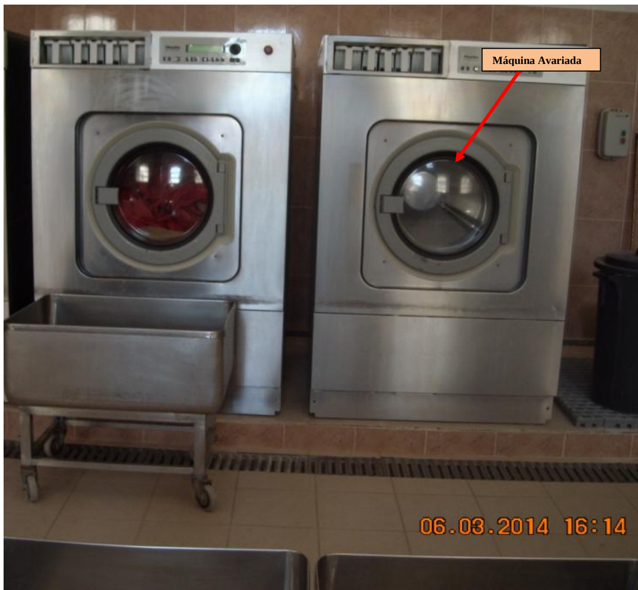
Figura 30: Maquinas de lavar roupa de 32Kg existentes na lavandaria de reclusos.
