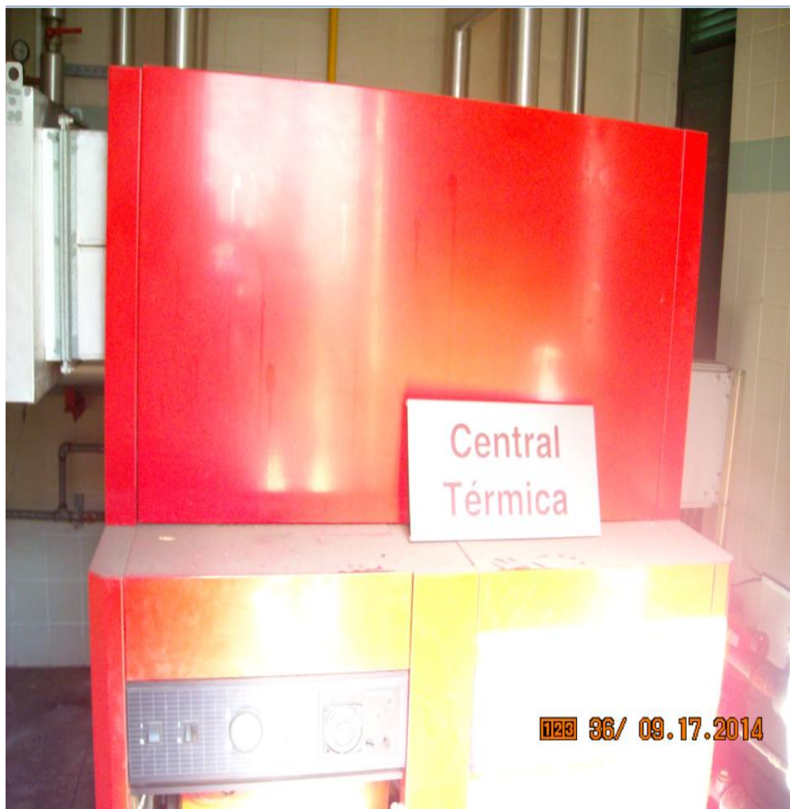
Figura 63: Central Térmica Localizada no edifício de Messe Pessoal pra produção de AQS à cozinha.
