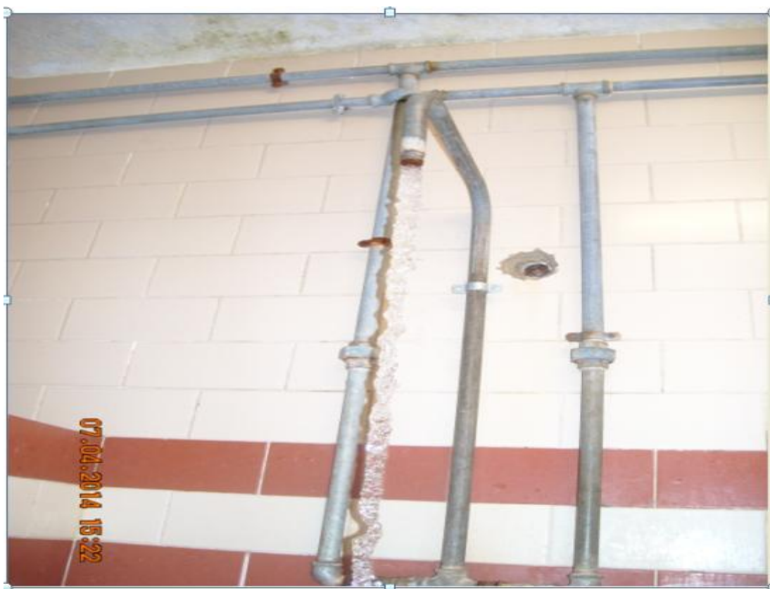
Figura 35: Falta de chuveiros nos tubos dos vários balneários existentes nas Alas Prisionais.
