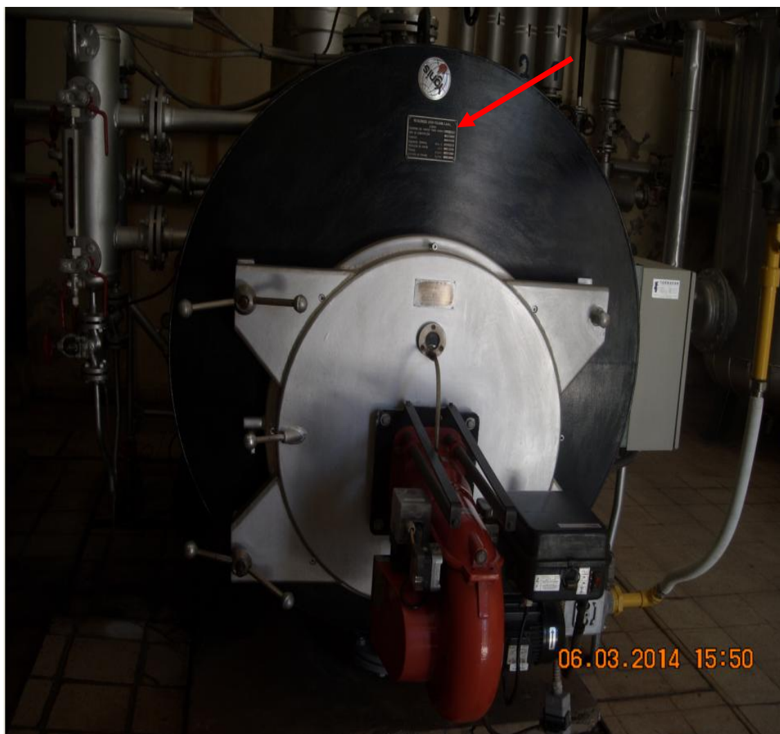
Figura 59: Vista de uma das Caldeira de produção de Águas Quentes Sanitárias.
