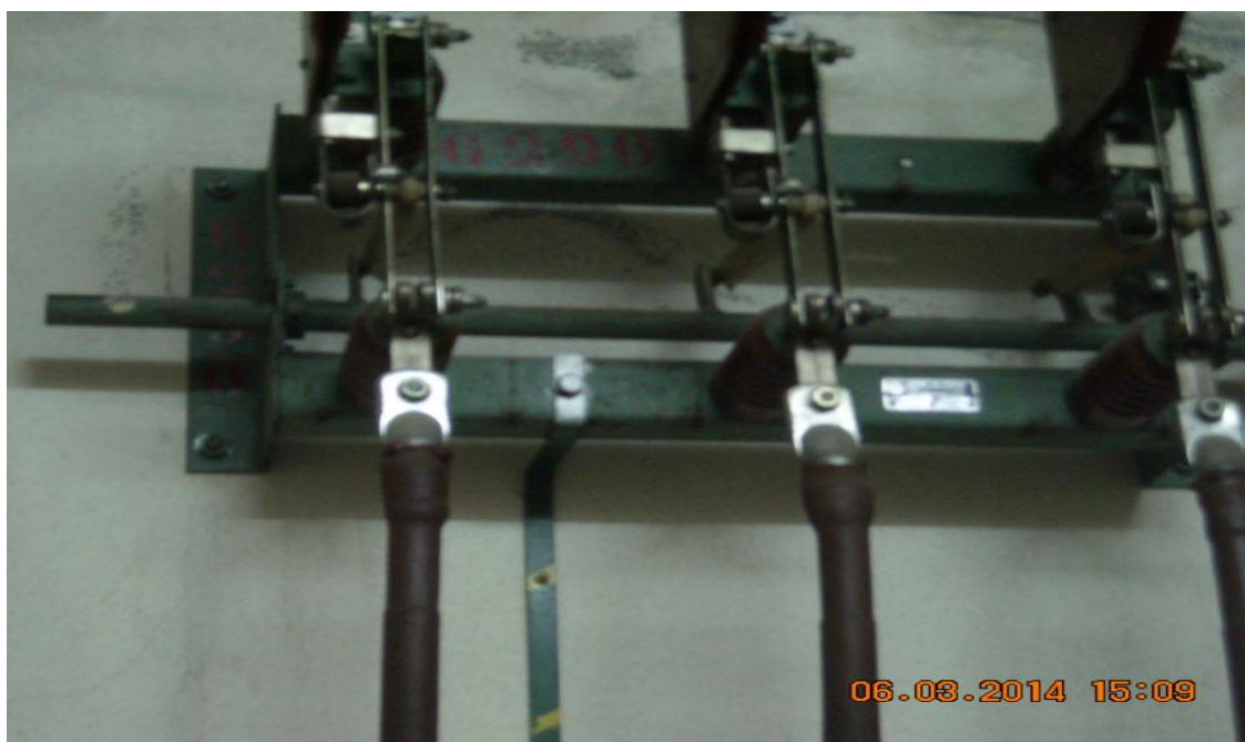
Figura 41: PT – Dispositivo de corte em média tensão
