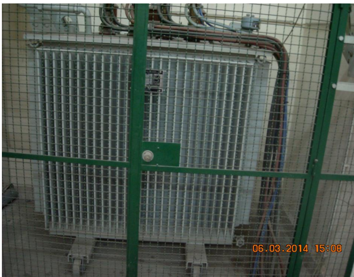
Figura 40: PT- Cella e transformador de potência 650 KVA e 11KV de tensão da rede.
