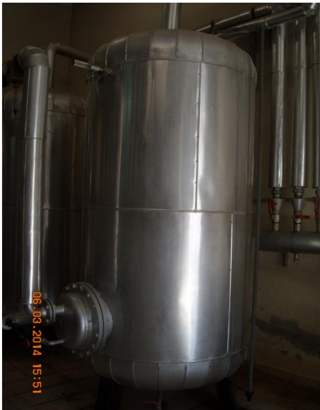
Figura 61: Um dos depósitos verticais para Conservação de AQS, recentemente instalados.
