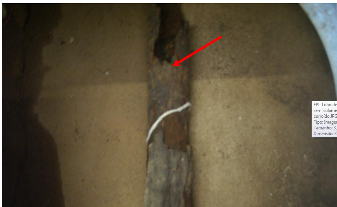
Figura 72: Outra imagem do mesmo tudo de águas quentes sanitárias (AQS) enterrado junto da caldeira.
