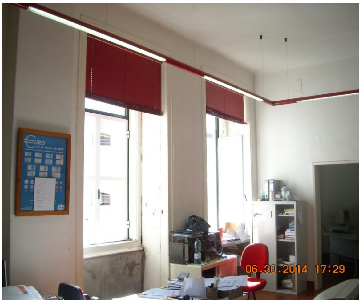
Figura 54: Iluminação de teto acesa durante o dia.
