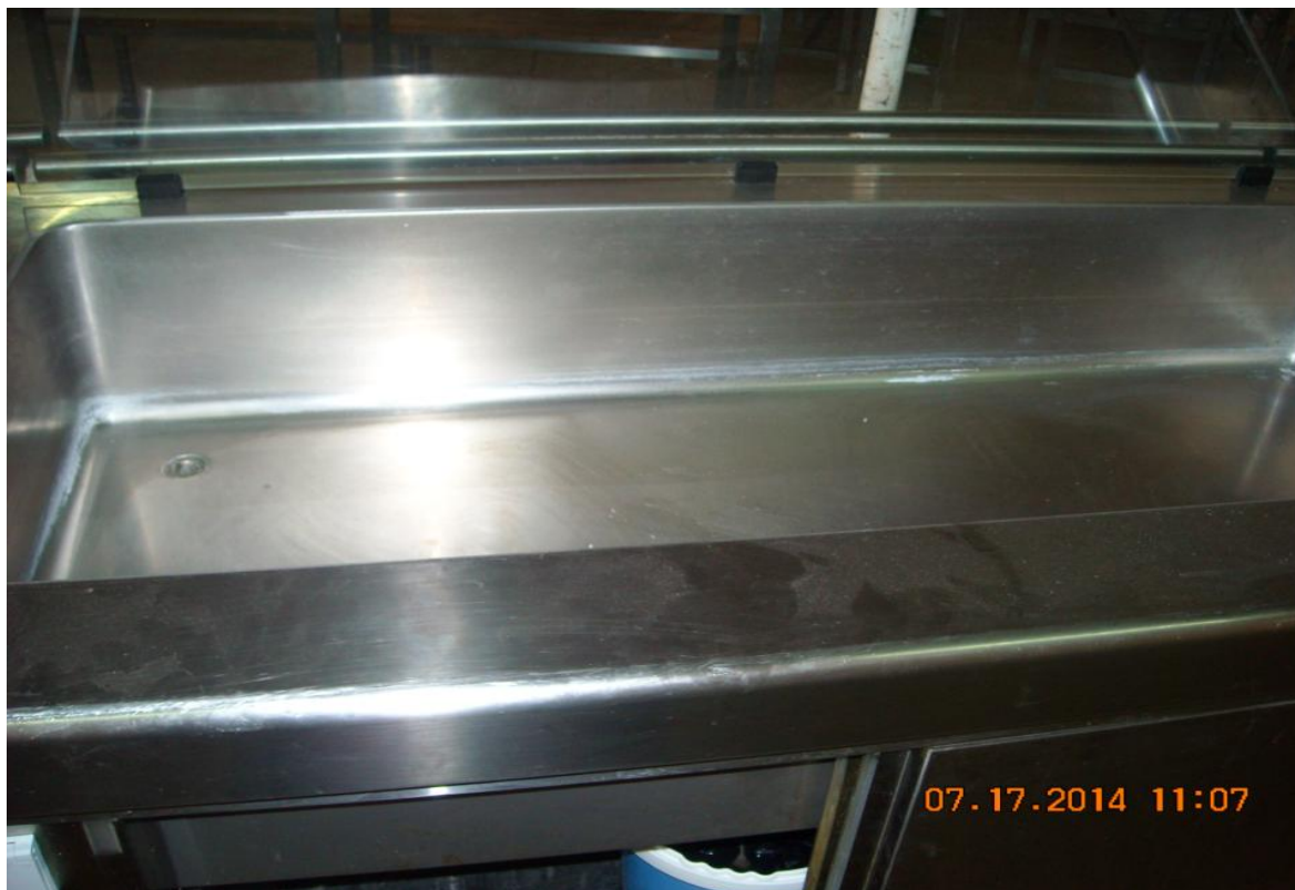
Figura 48: Balcão de aquecimento em banho-maria de marmitas de refeições, avariado.
