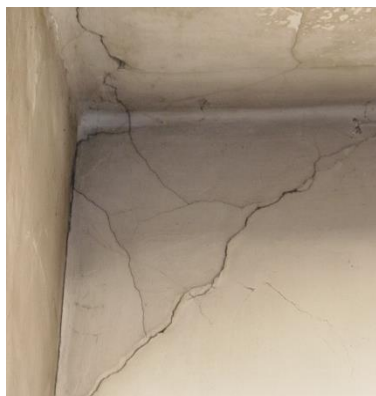
Figura 3.100 – Fissuras nas paredes interiores
