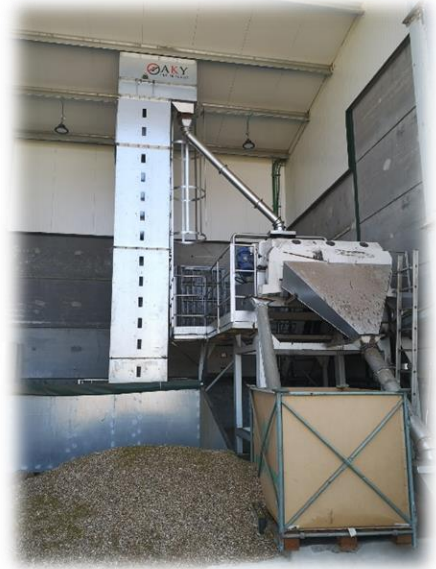
Figura 35- Máquinas de pré limpeza (Fertiprado, 2021)
