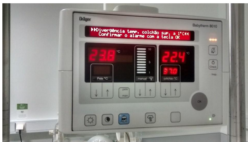
Figura 20 – Painel de controlo com modo manual e automático ( Fonte própria )
