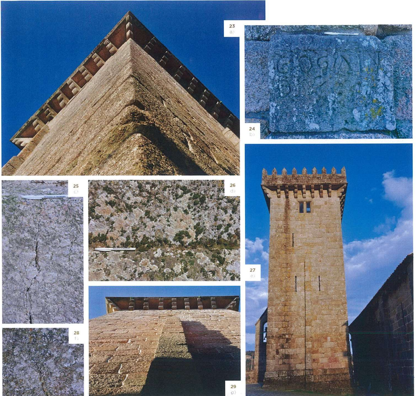
FIGURAS 23 A 29. Aspecto macroscópico das deteriorações da pedra das fachadas da Torre: a) pedras mais claras (limpas), situadas acima da cota correspondente à do beiral da Igreja, e forte recuo da superfície de algumas pedras (fachada sul); b) líquenes (fachada este); c) fissuras (fachada este); d) musgos e líquenes (fachada oeste); e) escorrência, filme biológico escuro e fissura; f) fissura (fachada oeste); g) pedras mais claras (limpas), situadas acima da cota correspondente à do beiral da Igreja, e afetadas por colonização biológica (sujas), abaixo do mesmo (fachada sul) (Begonha e Novais, 2011, p. 8).
