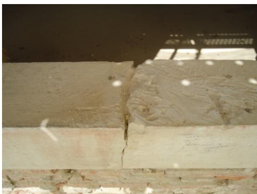
Figura 20 | Desalinhamento de elementos – Alçado Sudoeste, SO12
