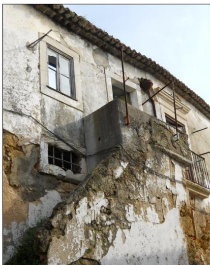
Figura 12 | Vista exterior dos vãos do compartimento em ruína [Piso 1] (Inês Jerónimo, 2011)
