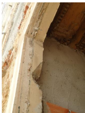
Figura 13 | Fractura resultante da remoção dos elementos metálicos de fixação dos caixilhos – Alçado Sudoeste, SO08
