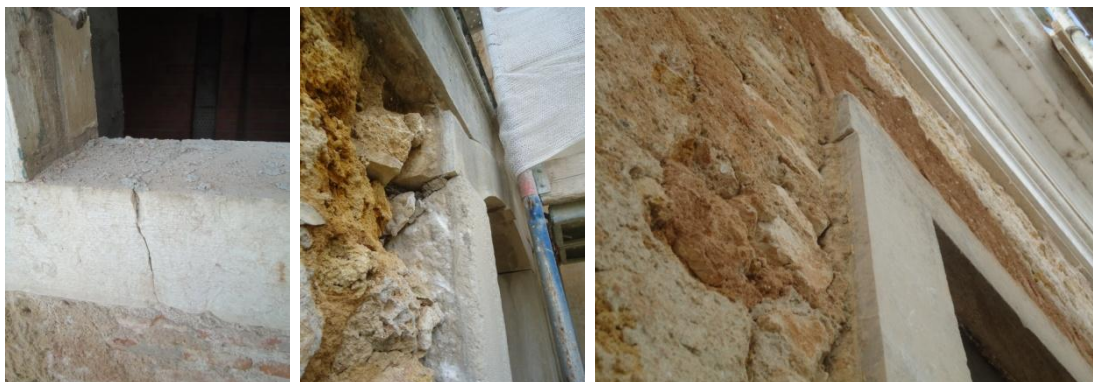
Figuras 16, 17 e 18 | Desalinhamento de elementos – Alçado Sudeste, SE04, SE09 e SE24, respectivamente
