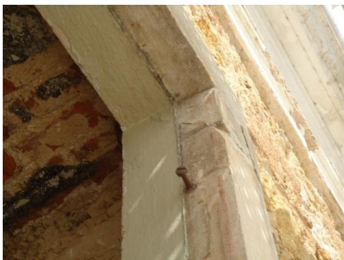
Figura 12 | Elemento metálico de fixação dos caixilhos – Alçado Sudoeste, SO12
