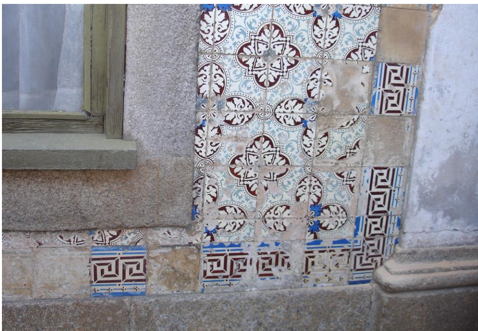
Aspecto de um dos painéis da fachada com extensas lacunas de vidro
