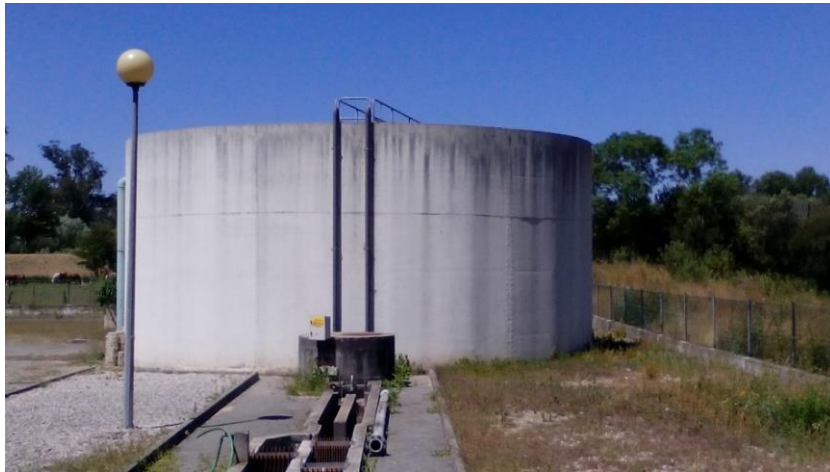
Figura 39 - Reator da ETAR 10 do Município de Montemor-o-Velho
