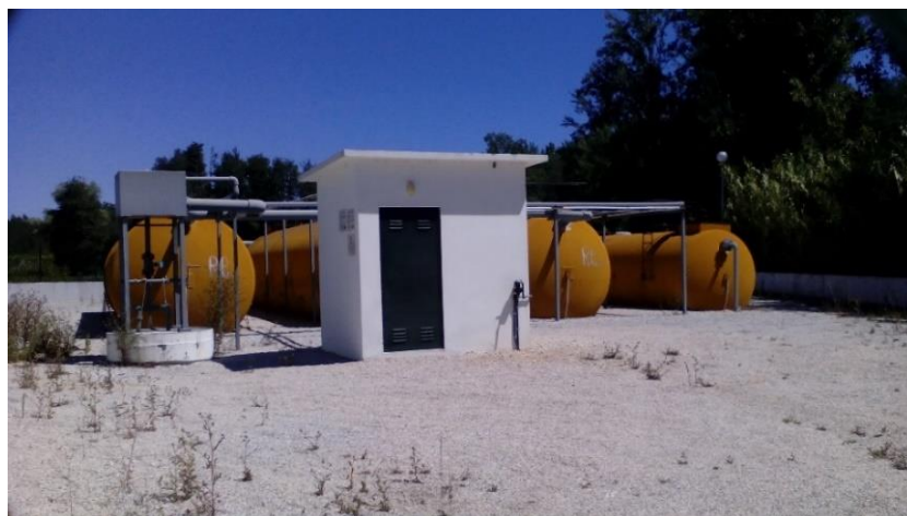
Figura 36 - Reatores compactos da ETAR 9 do Município de Montemor-o-Velho
