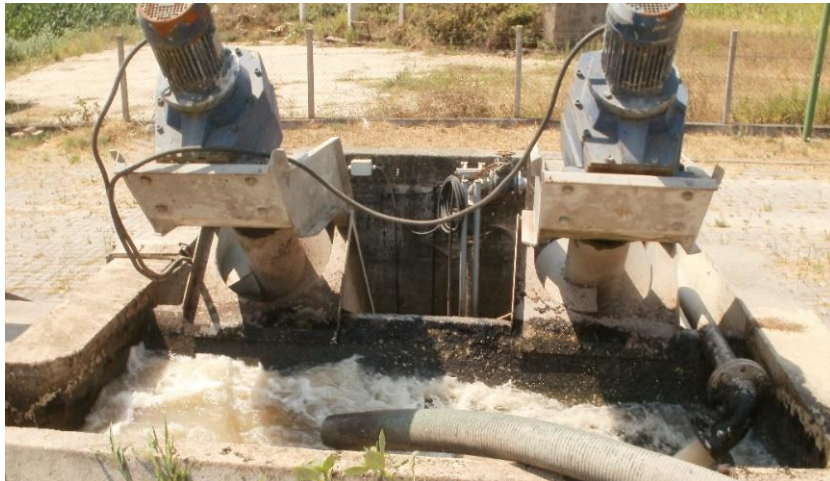
Figura 19 - Obra de entrada da ETAR 3 do Município de Montemor-o-Velho
