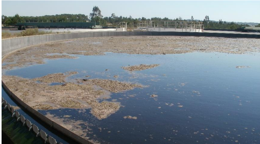
Figura 44 - Decantador secundário da ETAR Norte de Leiria/Coimbrão
