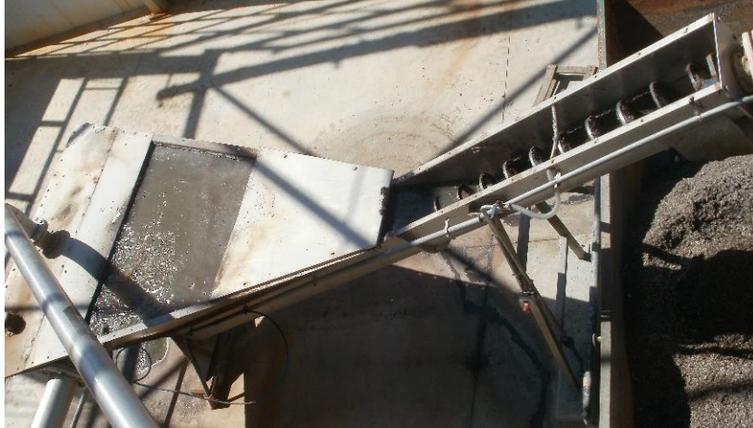
Figura 41 - Parafuso de Arquimedes na obra de entrada da ETAR Norte de Leiria/Coimbrão
