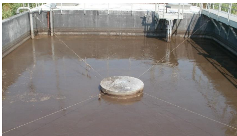
Figura 15 – Interior do reator SBR da ETAR 1 do Município de Montemor-o-Velho
