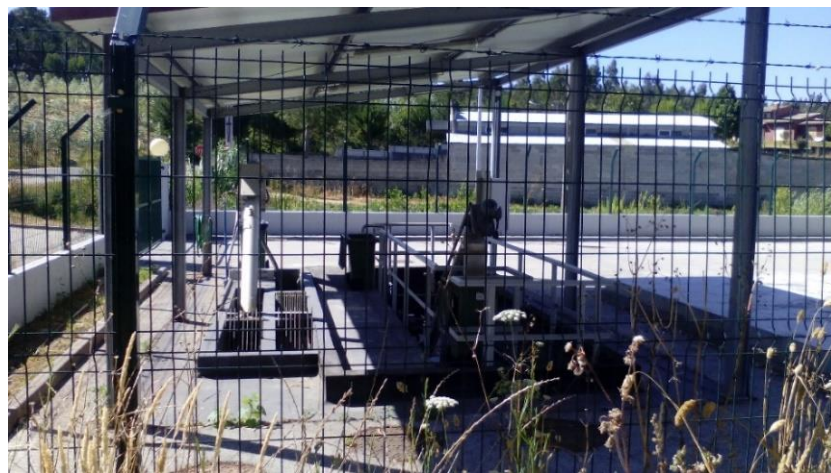
Figura 27 - Obra de entrada da ETAR 6 do Município de Montemor-o-Velho
