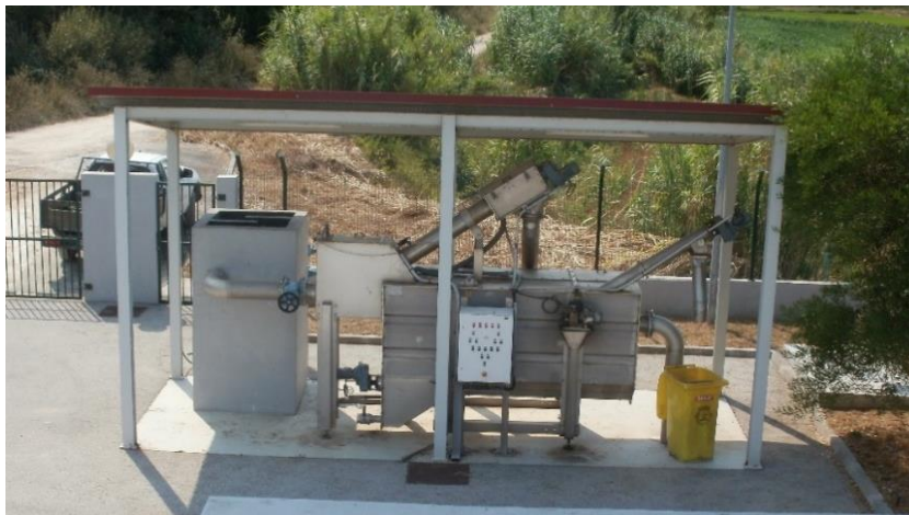
Figura 14 – Obra de entrada da ETAR 1 do Município de Montemor-o-Velho
