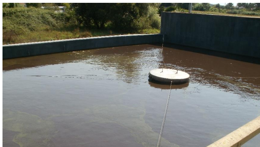
Figura 28 - Interior do reator SBR da ETAR 6 do Município de Montemor-o-Velho
