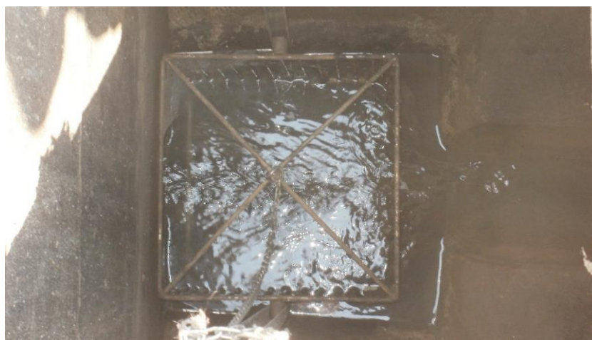
Figura 37 - Caixa de gradados da ETAR 9 do Município de Montemor-o-Velho
