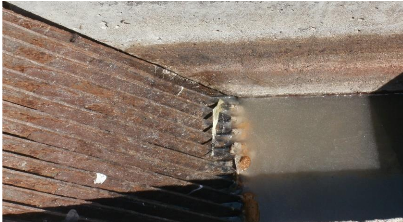
Figura 38 - Sistema de gradagem da ETAR 10 do Município de Montemor-o-Velho
