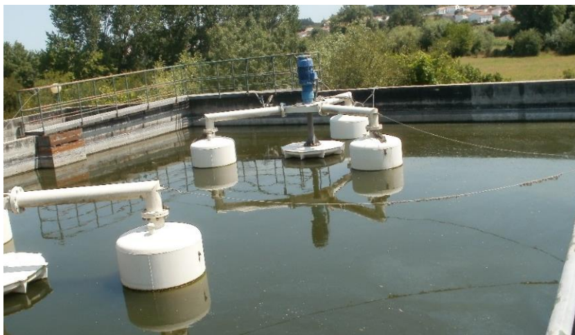
Figura 34 - Interior do reator da ETAR 8 do Município de Montemor-o-Velho
