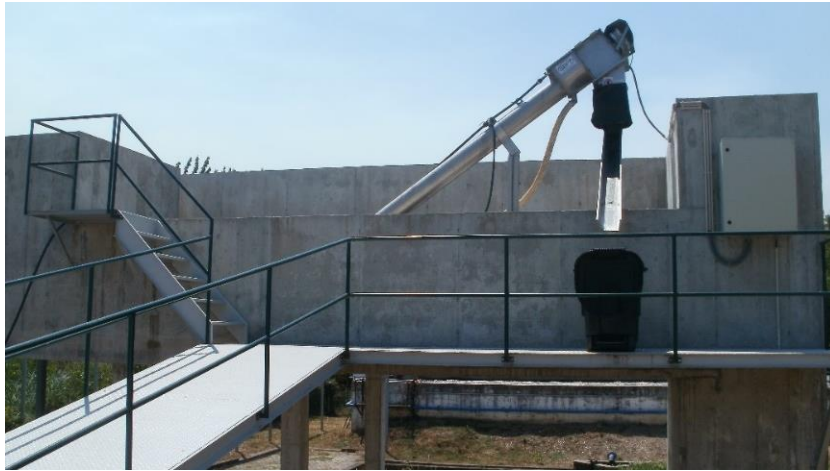
Figura 32 - Obra de entrada da ETAR 8 do Município de Montemor-o-Velho
