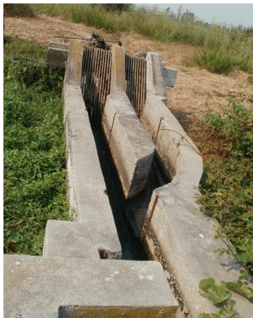
Figura 24 - Obra de entrada com gradagem da ETAR 4 do Município de Montemor-o-Velho
