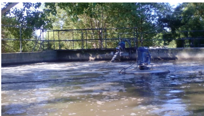
Figura 30 - Interior do reator da ETAR 7 do Município de Montemor-o-Velho
