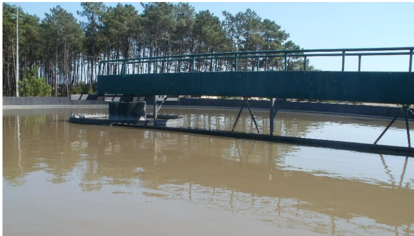
Figura 42 - Decantador primário da ETAR Norte de Leiria/Coimbrão
