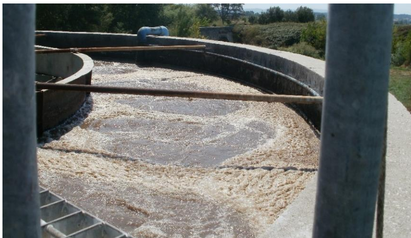
Figura 40 - Interior do reator da ETAR 10 do Município de Montemor-o-Velho
