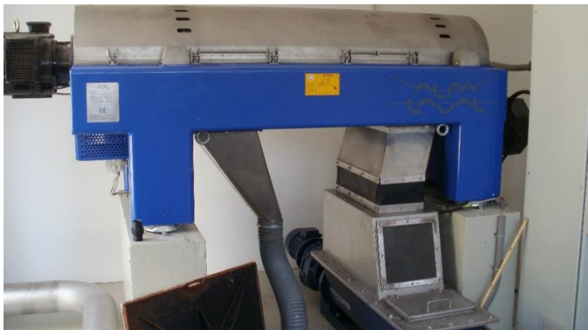
Figura 18 - Sistema de desidratação de lamas da ETAR 2 do Município de Montemor-o-Velho
