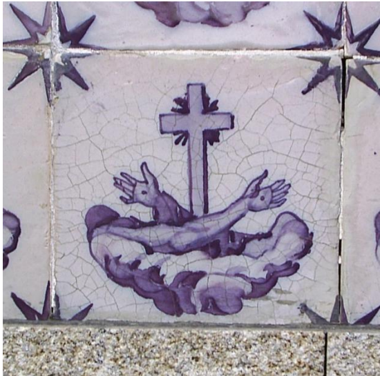
Fissuração generalizada de vidro
